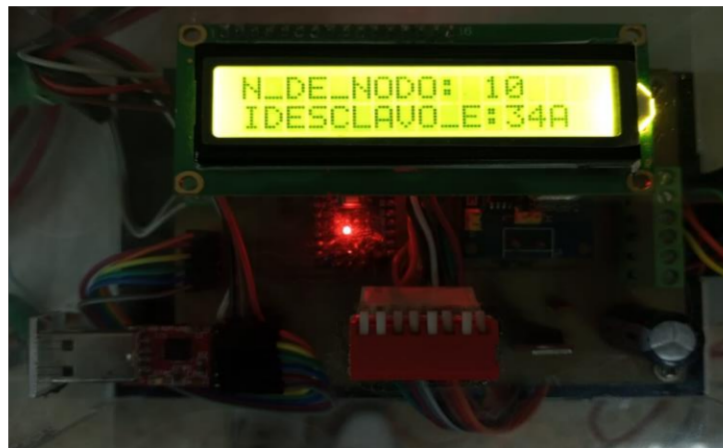
Figura 3.6. Dispositivo en modo de operación al desactivar interruptor 7
