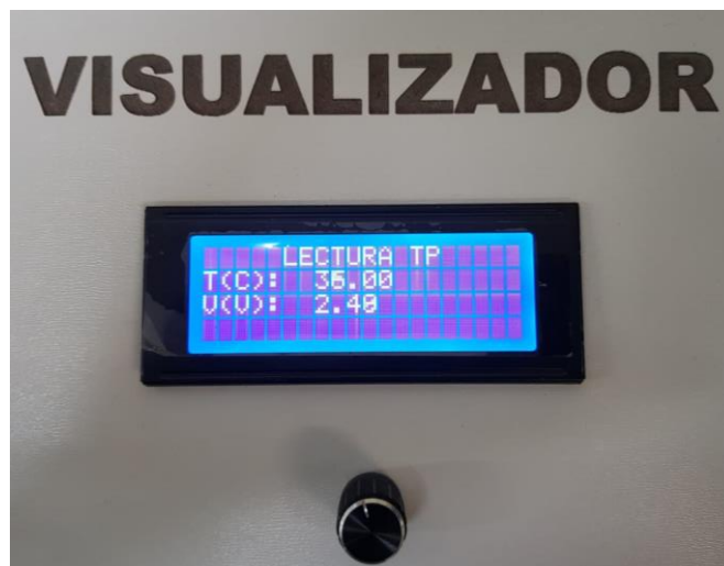
Figura 2.19. Lectura de temperatura y voltaje (Termopar)
