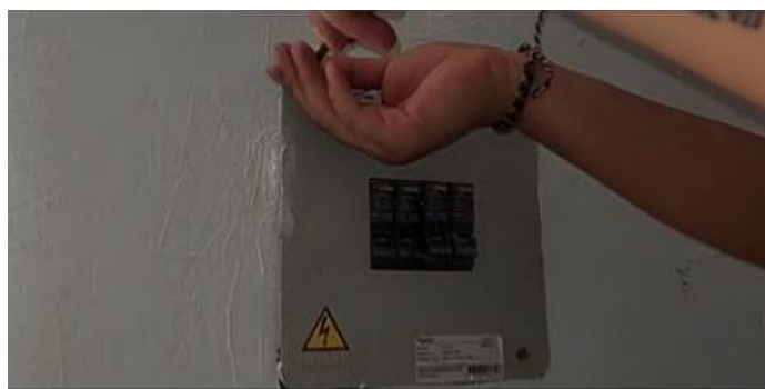
Figura 0.37 Retiro de la tapa de la caja de distribución
