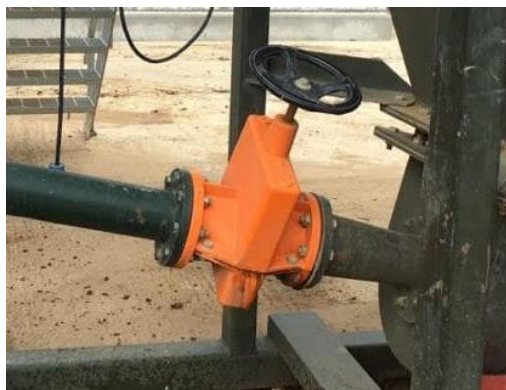
Figura 1.12. Tratamiento de aguas residuales
