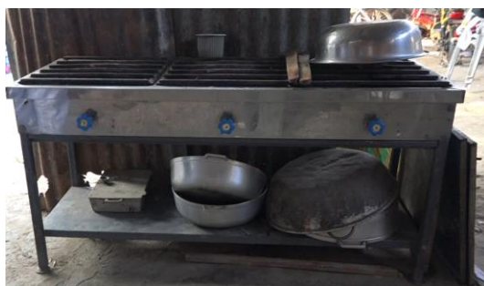
Figura 20. Área de cocción (cocina industrial)
