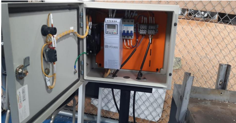
Figura 2.11. Convertidor de frecuencias. (Fuente Propia)
