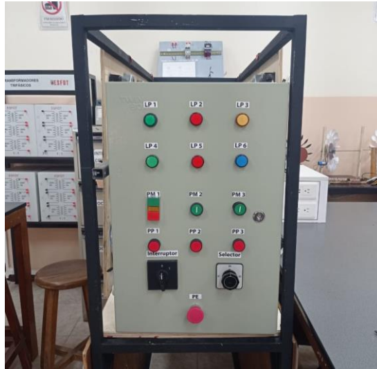
Figura 3.8 Tablero eléctrico principal
