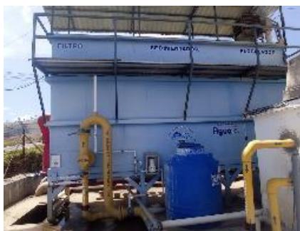
Figura 6. Planta prefabricada de tratamiento de agua potable Chinchinloma
