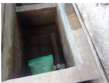
Figura 8. Pastillas de ácido tricloroisocianúrico en el tanque de desinfección
