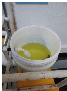
Figura 3. Hipoclorador con flotador
