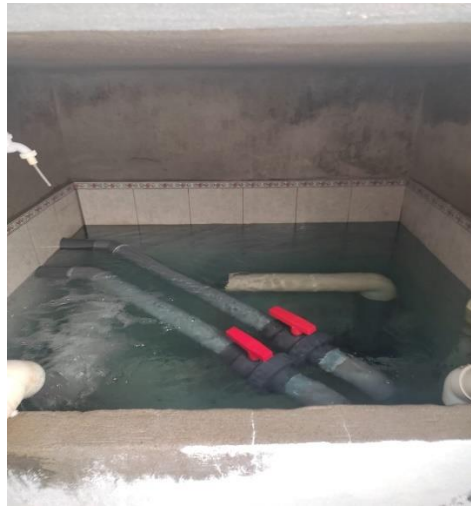
Figura 24. Tanque de contacto
