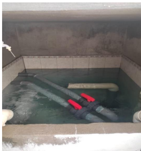
Figura 4. Tanque de contacto
