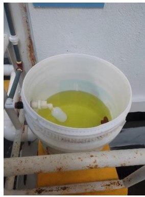
Figura 23. Hipoclorador con flotador
