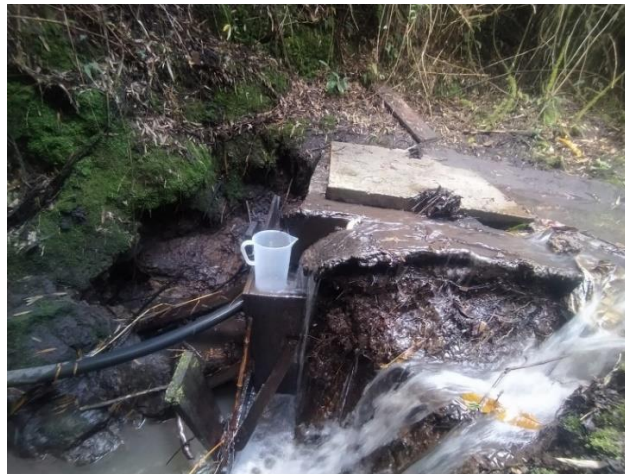
Figura 2.3. Captación agua superficial
