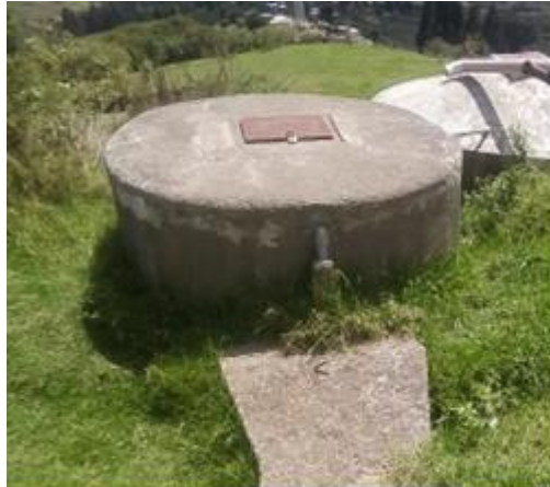
Figura 3.4. Tanque de almacenamiento principal existente
