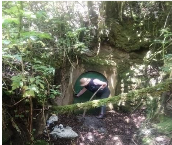
Figura 2.4. Galería de infiltración
