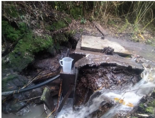
Figura 3.1. Captación superficial existente
