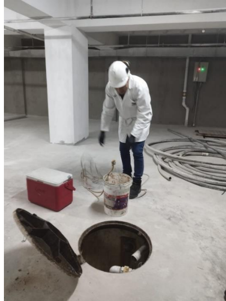
Figura 16. Sistema para recoger agua freática en el pozo 4
