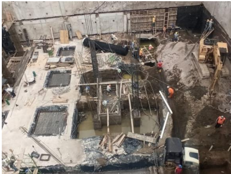
Figura 3. Nivel freático alto en la cimentación de Engadí
