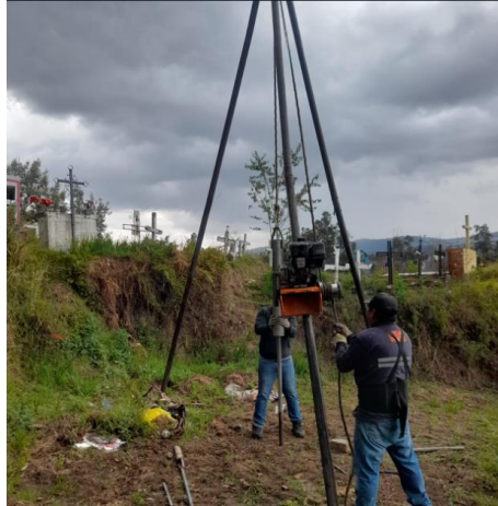
Figura 7. Perforación de suelo con el equipo SPT en el cementerio de Guangopolo
