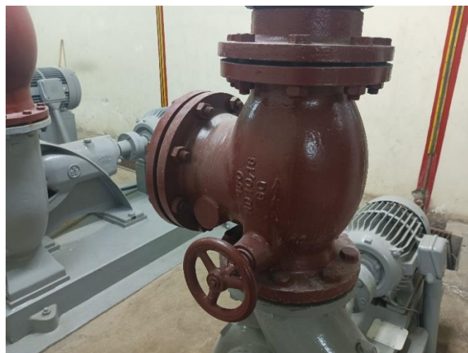
Figura 2.6 Válvulas del LDH
