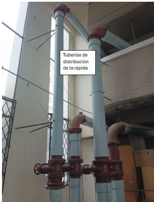
Figura 2.9 Tuberías de distribución de caudal a la rápida
