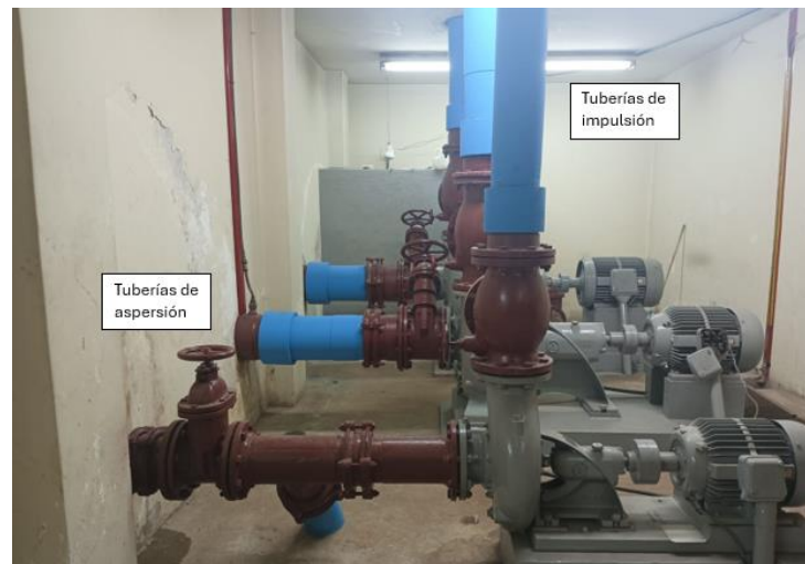
Figura 2.5 Tuberías de aspersión e impulsión
