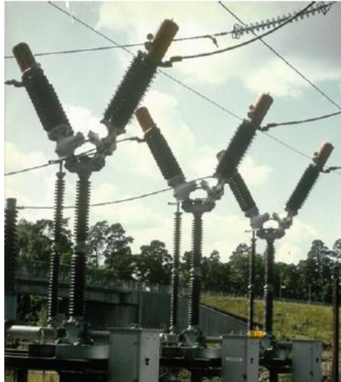
Figura 1.5: Disyuntor de tanque vico de aceite mínimo 245 kV de 1985[1]
