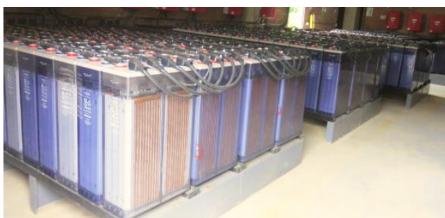
Figura 1.6. Cuarto de baterías, Isla Fuerte [7]
