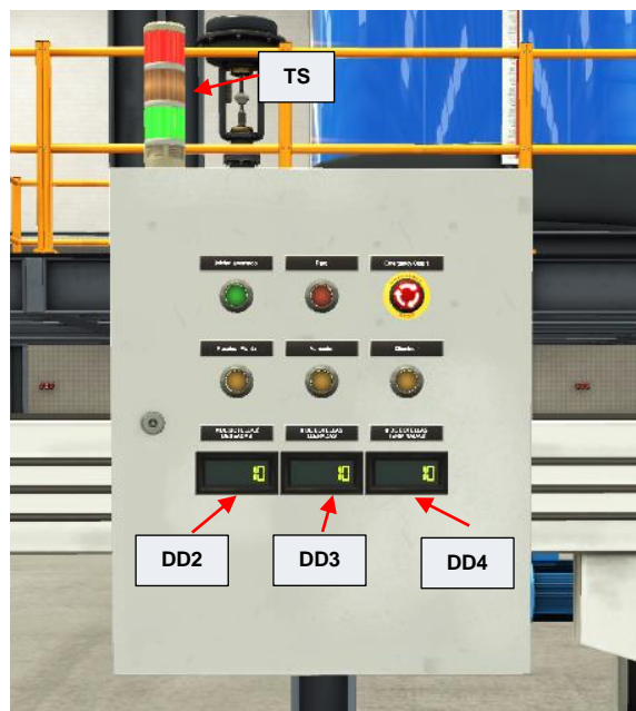
Figura 3.12. Tablero de control en Factory I/O.
