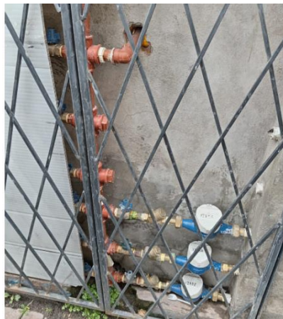
Figura 2.3 Medidores de agua potable.
