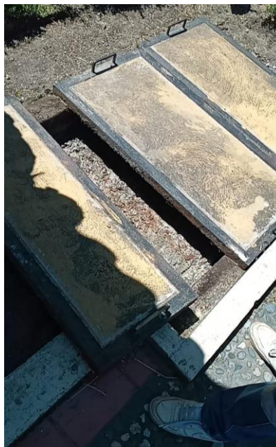
Figura 13: Entrada de la trampa de grasas – Elaboración propia
