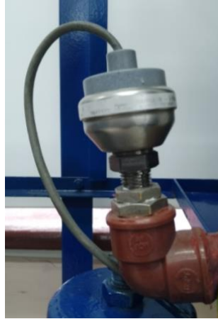
Figura 2.19. Transmisor de presión de la planta
