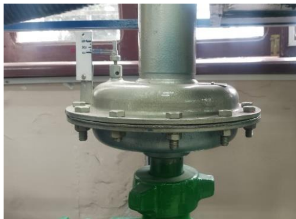
Figura 2.10. Reconocimiento de la válvula de control de nivel
