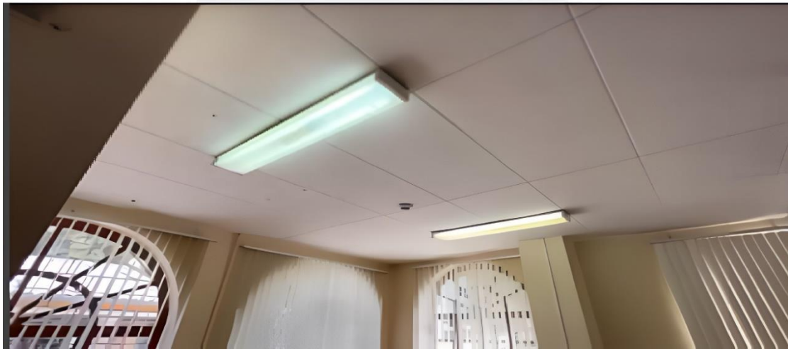
Figura 3.51 Encendido de la luminaria por medio de la interfaz web
