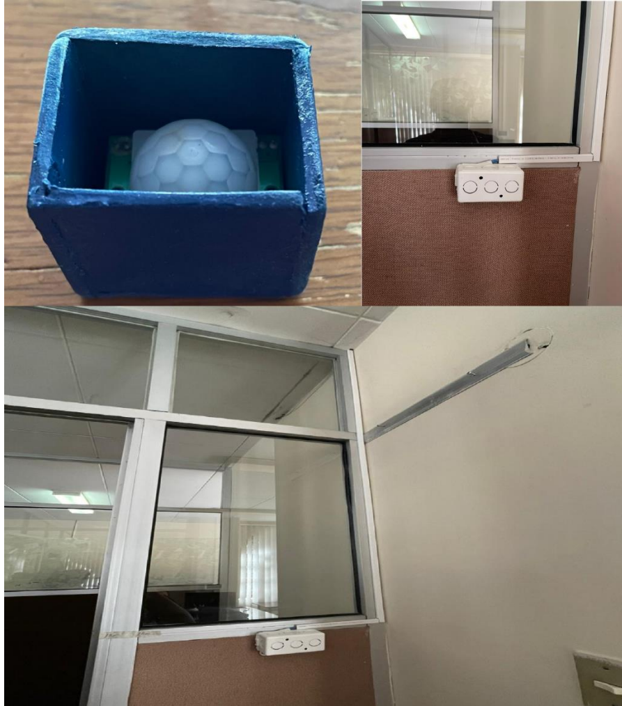
Figura 3.42 Implementación del sensor PIR en su caja de protección
