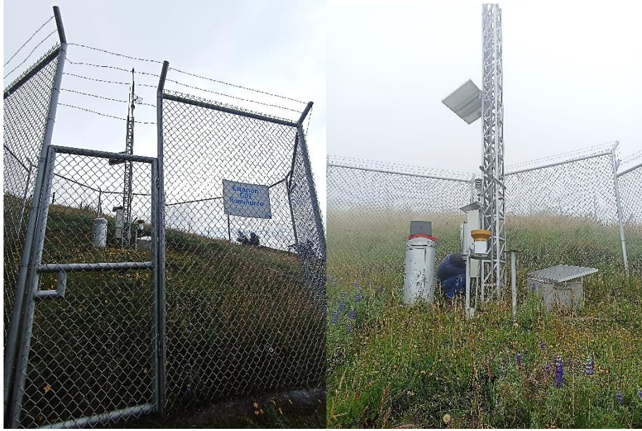
Figura 2. Vista (afuera/dentro) de la estación CO2
