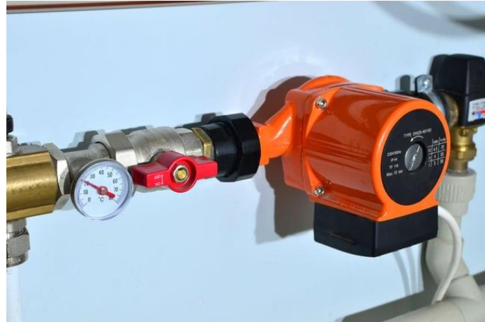
Figura 17. Bomba de recirculación con válvula de regulación.[23]
