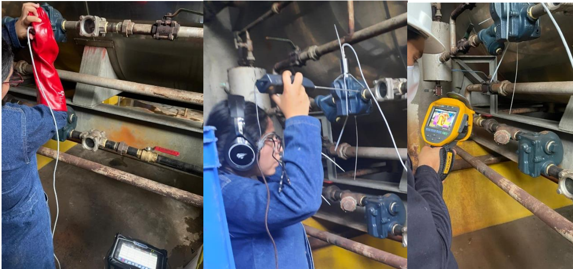
Figura 5.1. Inspecciones iniciales de temperatura y método auditivo de una trampa de flotador y termostato.
