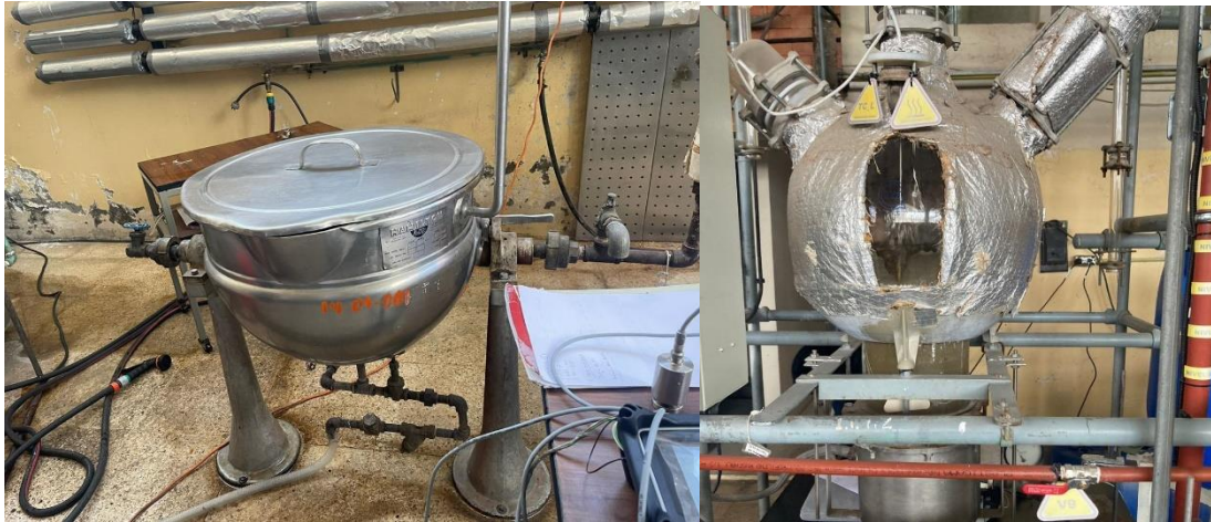
Figura 5.3. Equipos de consumo de la Planta Piloto DECAB.
