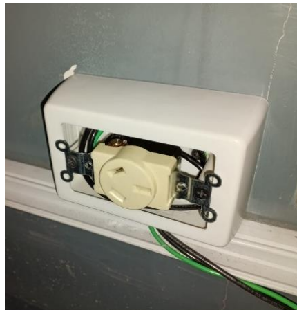
Figura 9. Conexión del tomacorriente Fuente: Autor
