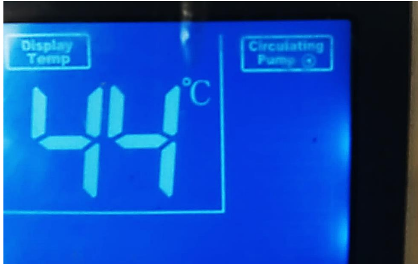
Figura 16. Elementos encendidos antes de entrar en operación
