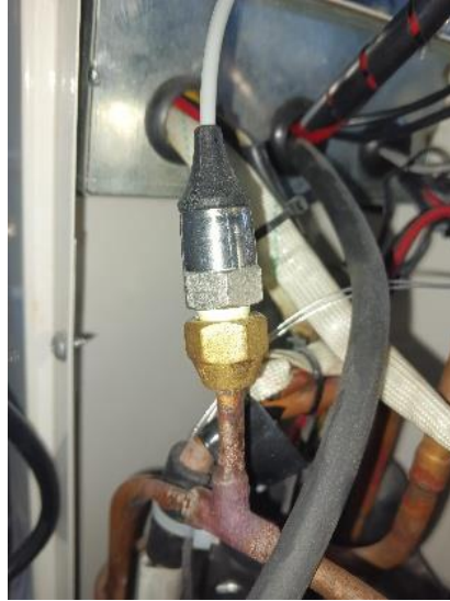
Figura 18. Instalación del transductor de presión SB69-500V Fuente: Autor
