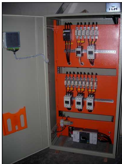
Figura 2.8 Banco de condensadores (interior)
