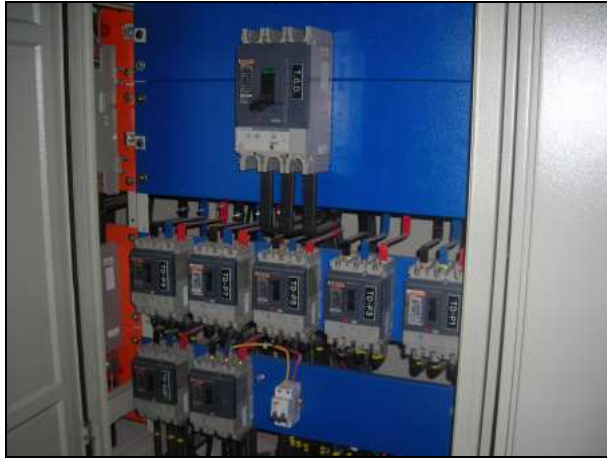
Figura 2.6 Tablero General de Distribución (interior)
