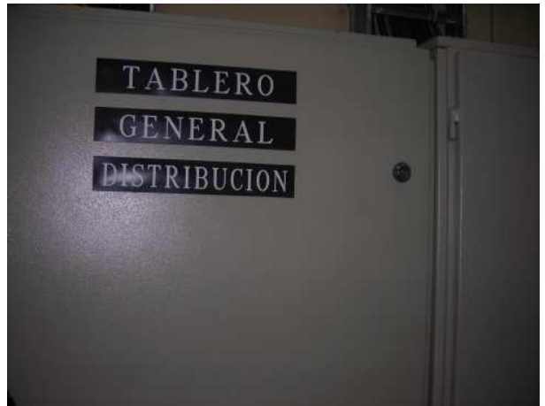
Figura 2.5 Tablero General de Distribución (exterior)
