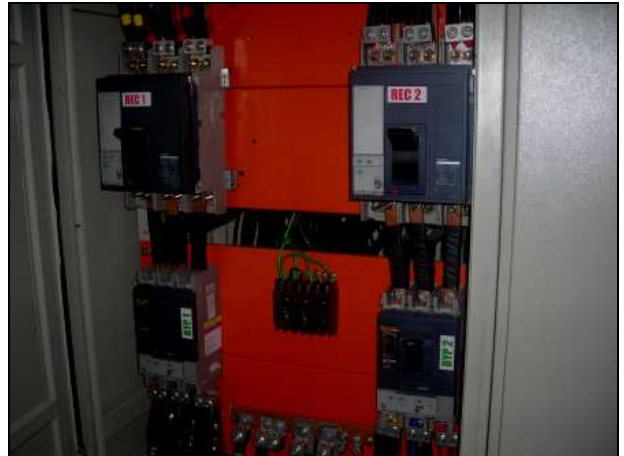
Figura 2.4 Tablero de Distribución Principal UPS (interior)
