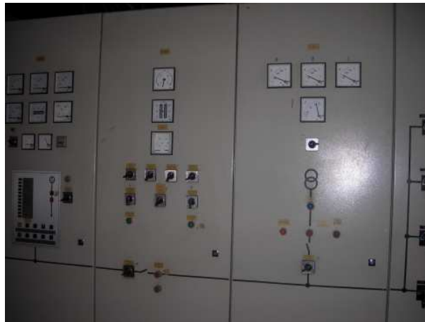
Figura 2.11 Control de energía
