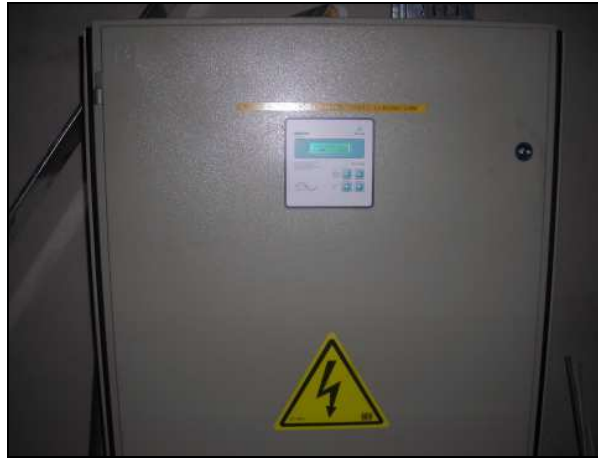
Figura 2.7 Banco de condensadores (exterior)
