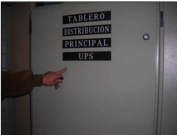
Figura 2.3 Tablero de Distribución Principal UPS (exterior)
