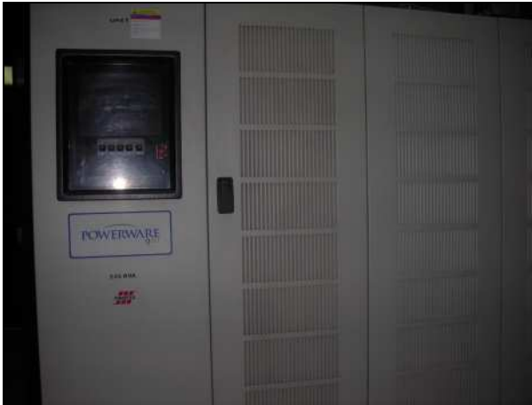
Figura 2.2. UPS PowerWare 9315 225 KVA Firmesa
