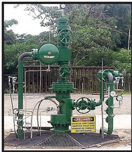
FIGURA 2.3 CABEZAL DEL POZO
