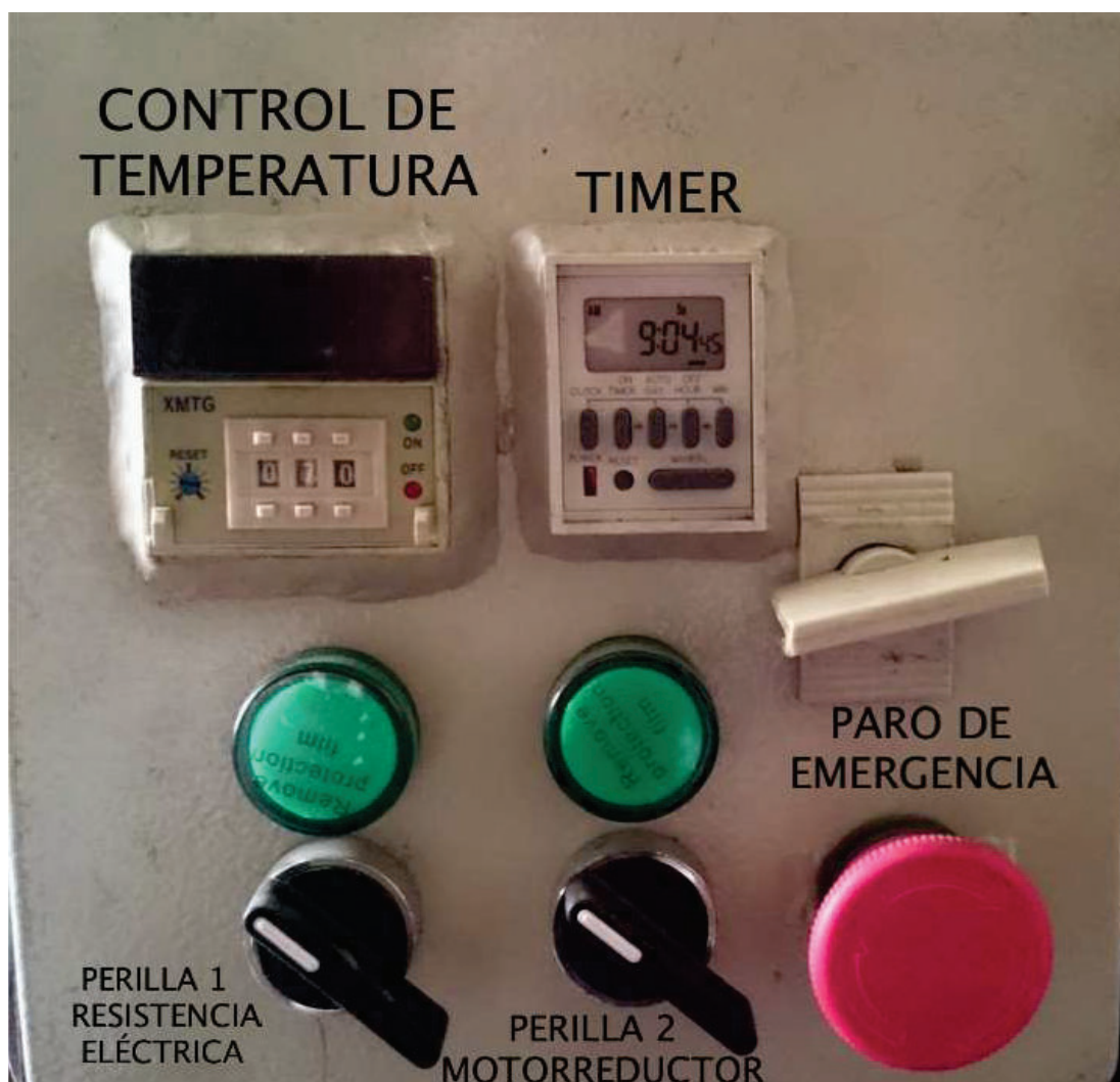
Figura 7.16 Caja de Control Eléctrico
