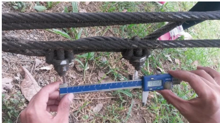
Figura 4.19 Separación de las abrazaderas de anclaje de salida Fuente: propia
