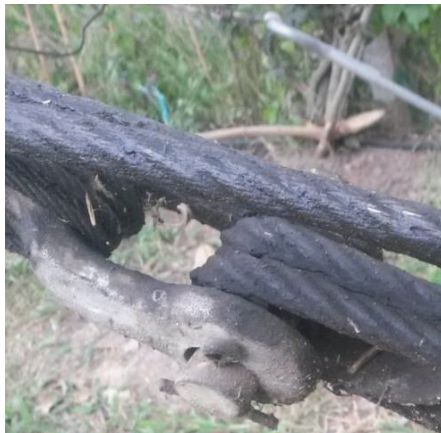
Figura 4.26 Grillete anclaje de salida ruta 1 Fuente: propia
