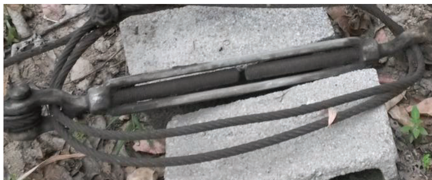
Figura 4.30 Tensor anclaje de llegada ruta 2 Fuente: propia
