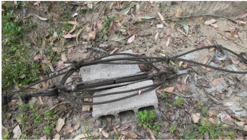
Figura 4.16 Anclaje de llegada de la ruta 2 Fuente: propia
