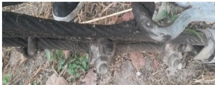
Figura 4.20 Abrazaderas en empalmes de cables anclaje de salida Fuente: propia
