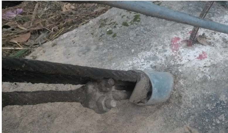
Figura 4.33 Anclaje de salida ruta 1 Fuente: propia
