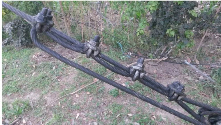
Figura 4.18 Abrazaderas en el anclaje de salida Fuente: propia
