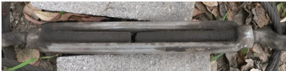
Figura 4.29 Tensor anclaje de llegada ruta 2 Fuente: propia
