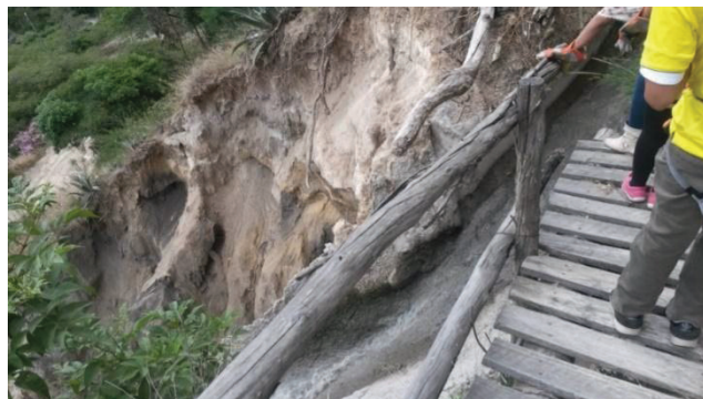
Figura 4.51 Zona de posible deslave Fuente: propia
