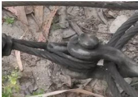
Figura 4.25 Guardacabos anclaje de llegada ruta 2 Fuente: propia
