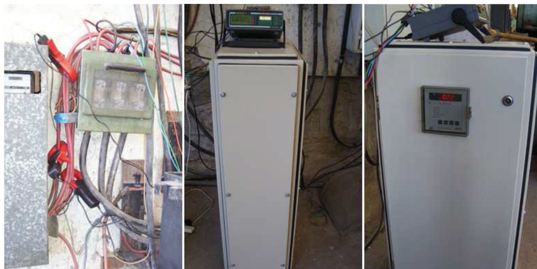
Figura 4.1. Montaje de analizador industrial MICROVIP3
