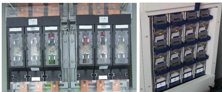
Figura 5. 19 Ejemplo de fusibles de alto poder de ruptura (APR) en el lado de bajo voltaje del transformador.
