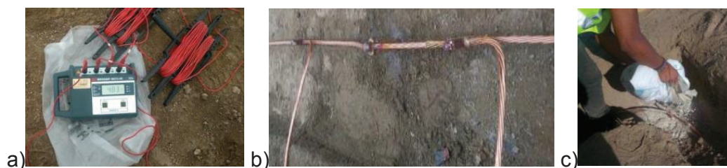
Figura 3. 54 a) Medición de puesta a tierra b) Verificación de conexiones c) Mejora del sistema de puesta a tierra.
