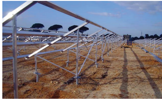
Figura 2. 21 Estructuras de Soporte
