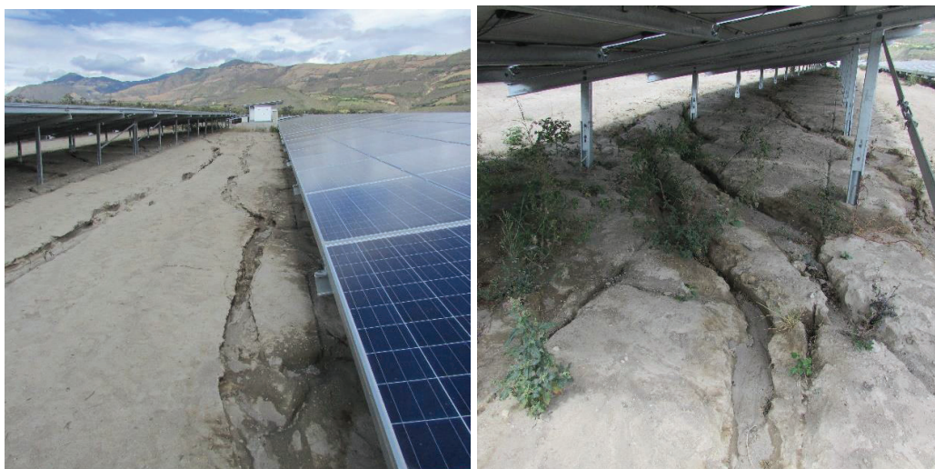
Figura 3. 39 Grietas en el terreno de un parque fotovoltaico.
