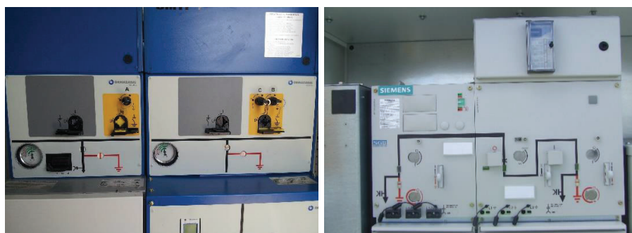
Figura 3. 52 Ejemplo de equipos de conexión en medio voltaje.
