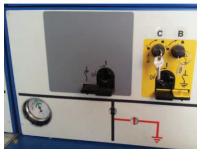
Figura 5. 18 Vista frontal de una celda de medio voltaje, ejemplo 2.
