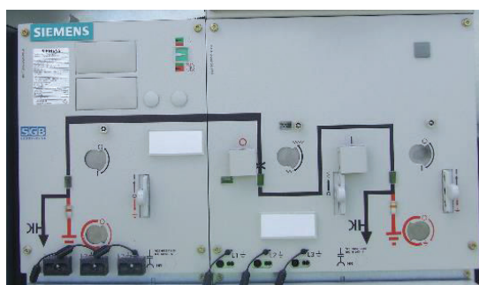
Figura 5. 17 Vista frontal de una celda de medio voltaje, ejemplo 1.
