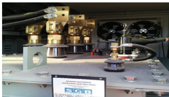
Figura 3. 51 Ejemplo de transformador de medio voltaje de una central fotovoltaica.
