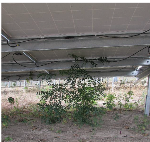
Figura 3. 38 Maleza en la parte posterior de los paneles.
