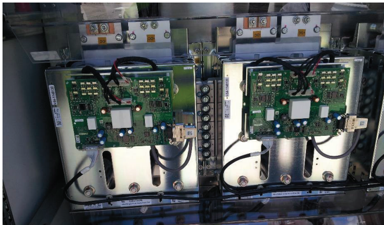
Figura 2. 31 Ejemplo de módulos inversores.
