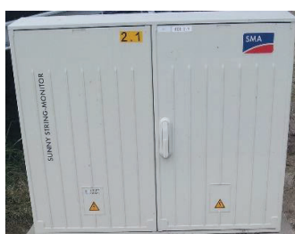
Figura 2. 26 Estructura armario de un equipo de conexión de arreglos de paneles.
