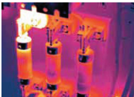
Figura 3. 50 Termografía en equipos eléctricos.
