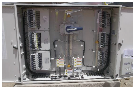
Figura 5. 21 Equipo de conexión de strings. Interruptor de potencia de DC ubicado en la parte central.
