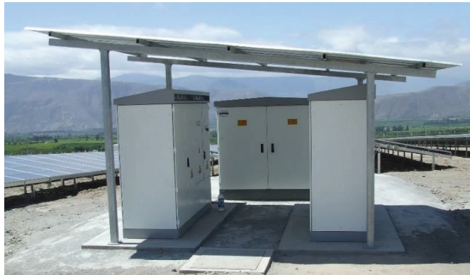
Figura 3. 48 Ejemplo de inversores instalados en el Ecuador.
