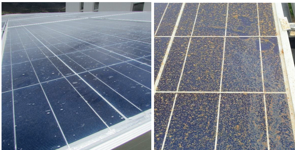
Figura 3. 41 Suciedad sobre los paneles.
