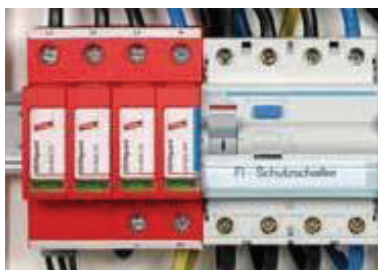
Figura 5. 22 Descargadores de sobretensión y sus indicadores.
