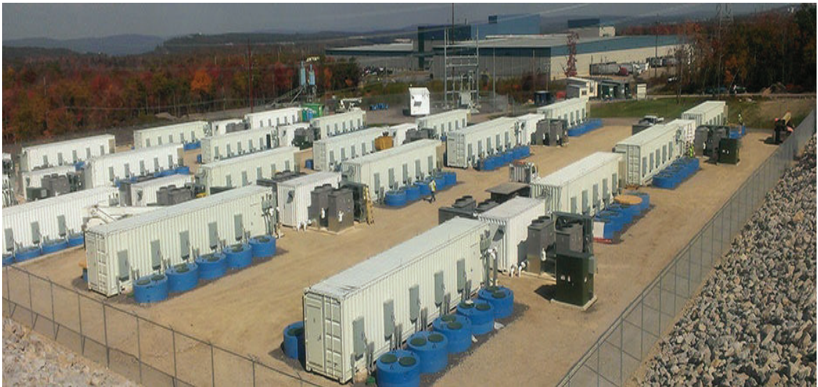
Figura 1.27 Planta de almacenamiento de energía Hazle Township Pensilvania
