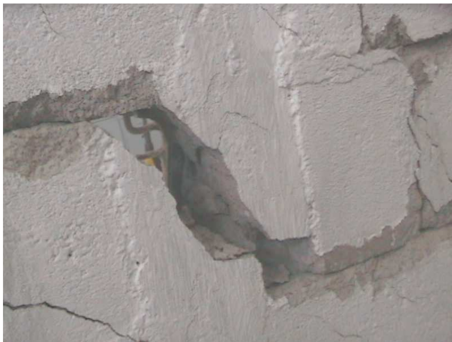
FIGURA 4 26 Fisuras horizontales en las juntas correspondientes al panel central.
