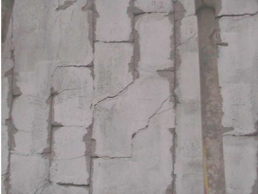
FIGURA 4.47 Fisuras diagonales localizadas, que atravesaron los mampuestos.
