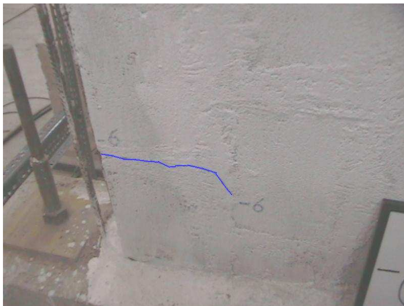
FIGURA 4.35 Primera fisura en pie de columneta izquierda a 6 t de carga negativa
