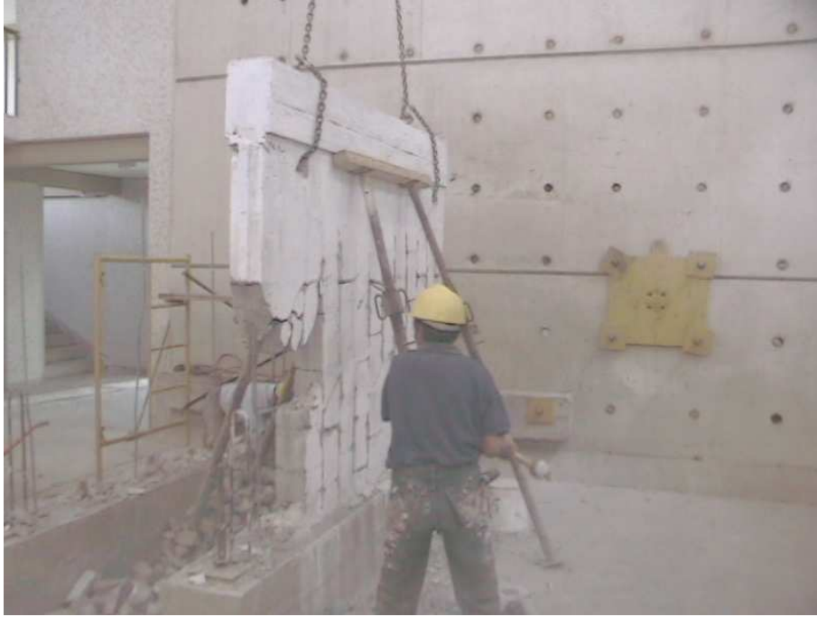
FIGURA 4.51 Derrocamiento total de pared.
