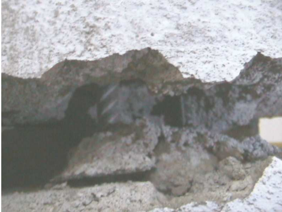
FIGURA 4.45 Desprendimiento del recubrimiento en acero por fallas de deslizamiento vertical.
