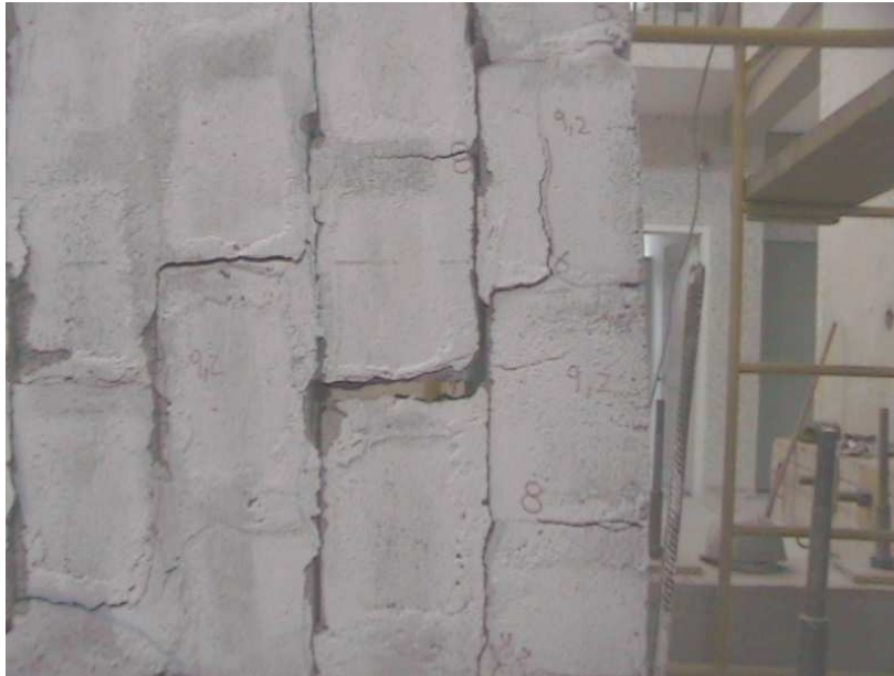
FIGURA 4.39 Fallas pronunciadas en la unión de los bloques.
