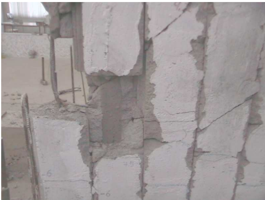
FIGURA 4.50 La falla en la base fue por deslizamiento, antes que por flexión.
