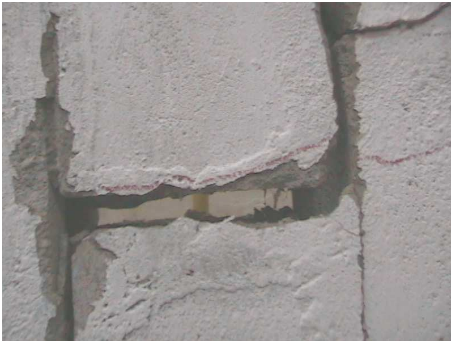
FIGURA 4.46 Deslizamiento vertical de los mampuestos.
