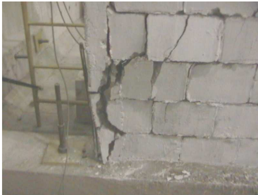
FIGURA 4.24 Fisuras por flexión en la base del panel izquierdo.
