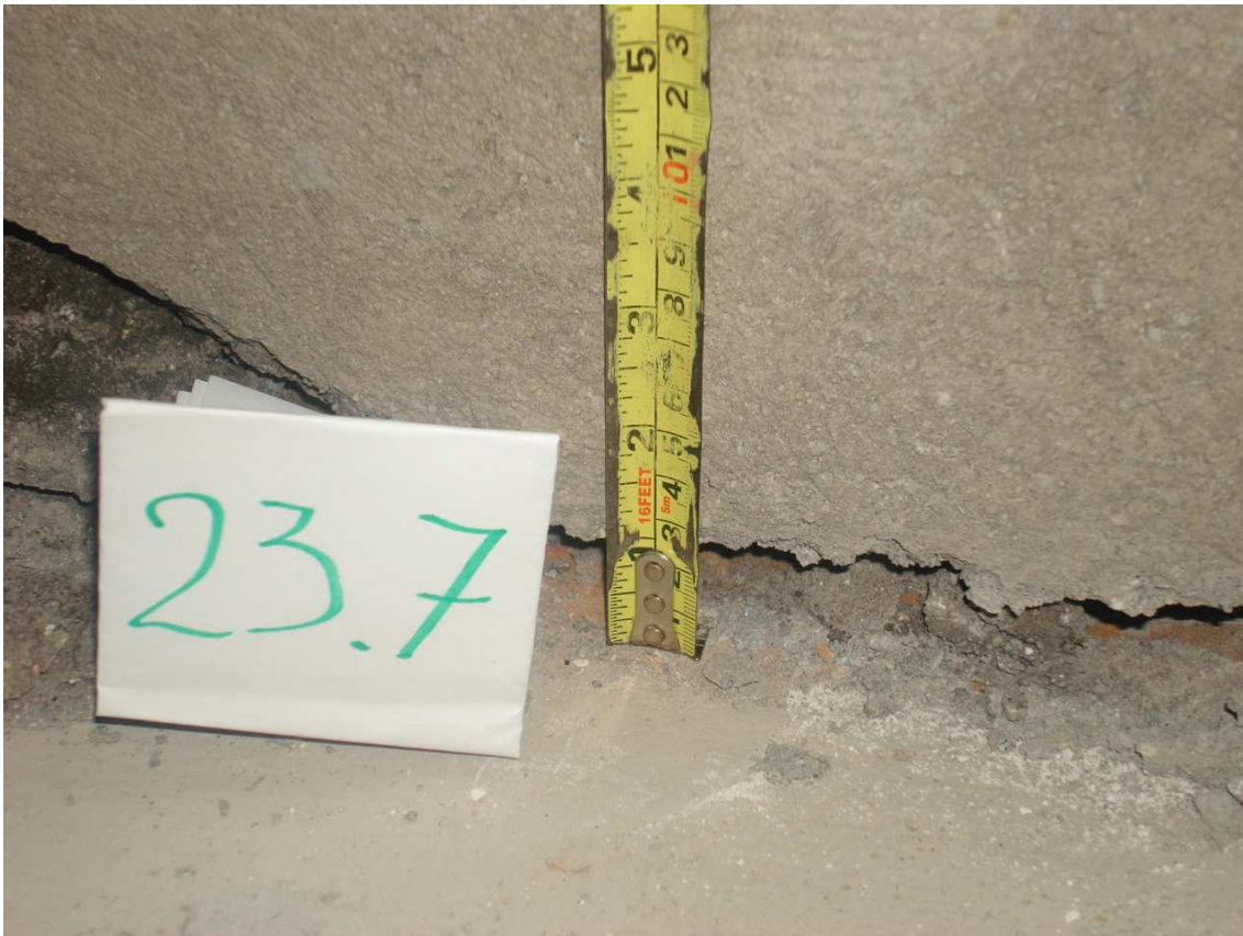
Fotografía 5.14: Efecto de volcamiento (levantamiento de la pared)
