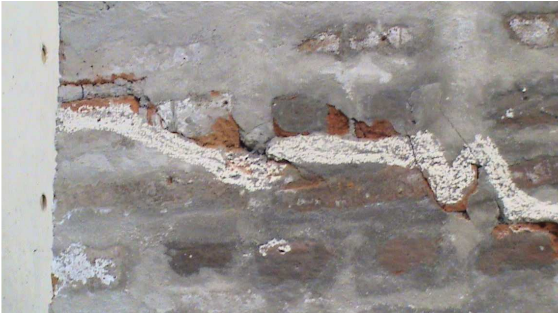
Fotografía 6.2: Grieta en esquina superior izquierda de la pared agotada.
