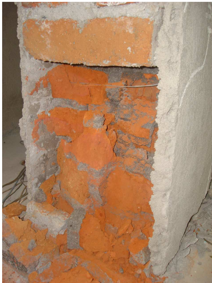
Fotografía 5.30: Desprendimiento de ladrillos. Terminado el ensayo.
