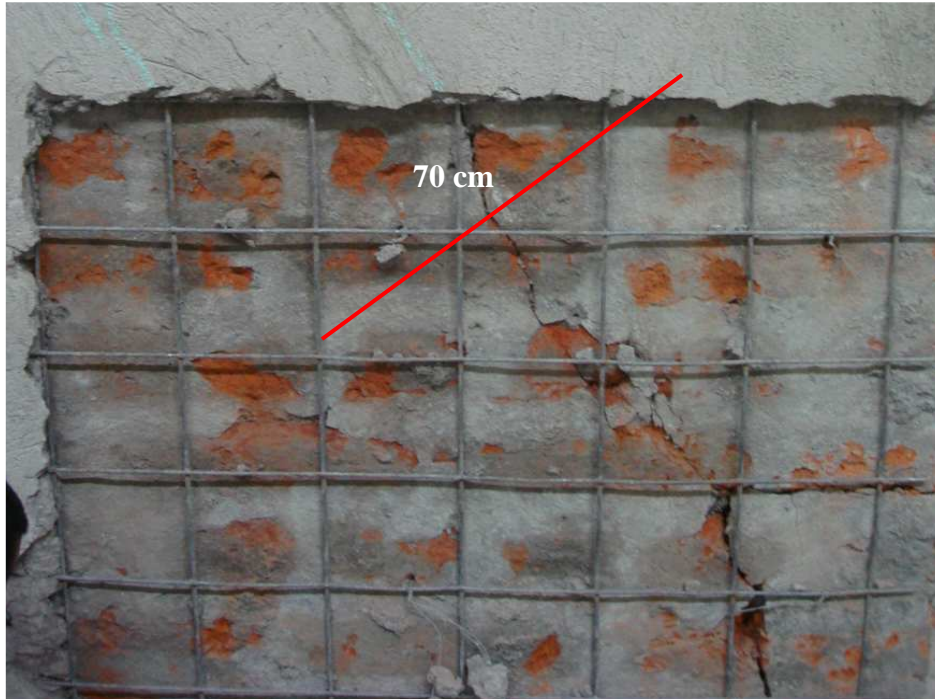
Fotografía 6.7: Mampostería descubierta no presenta agrietamiento masivo en las unidades cercanas a la grieta de falla.
