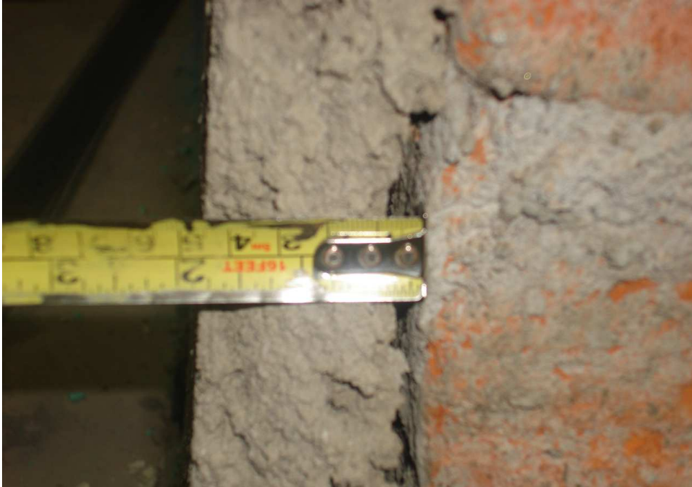
Fotografía 5.17: Desprendimiento de la capa de enchape a las 30 t de carga positiva
