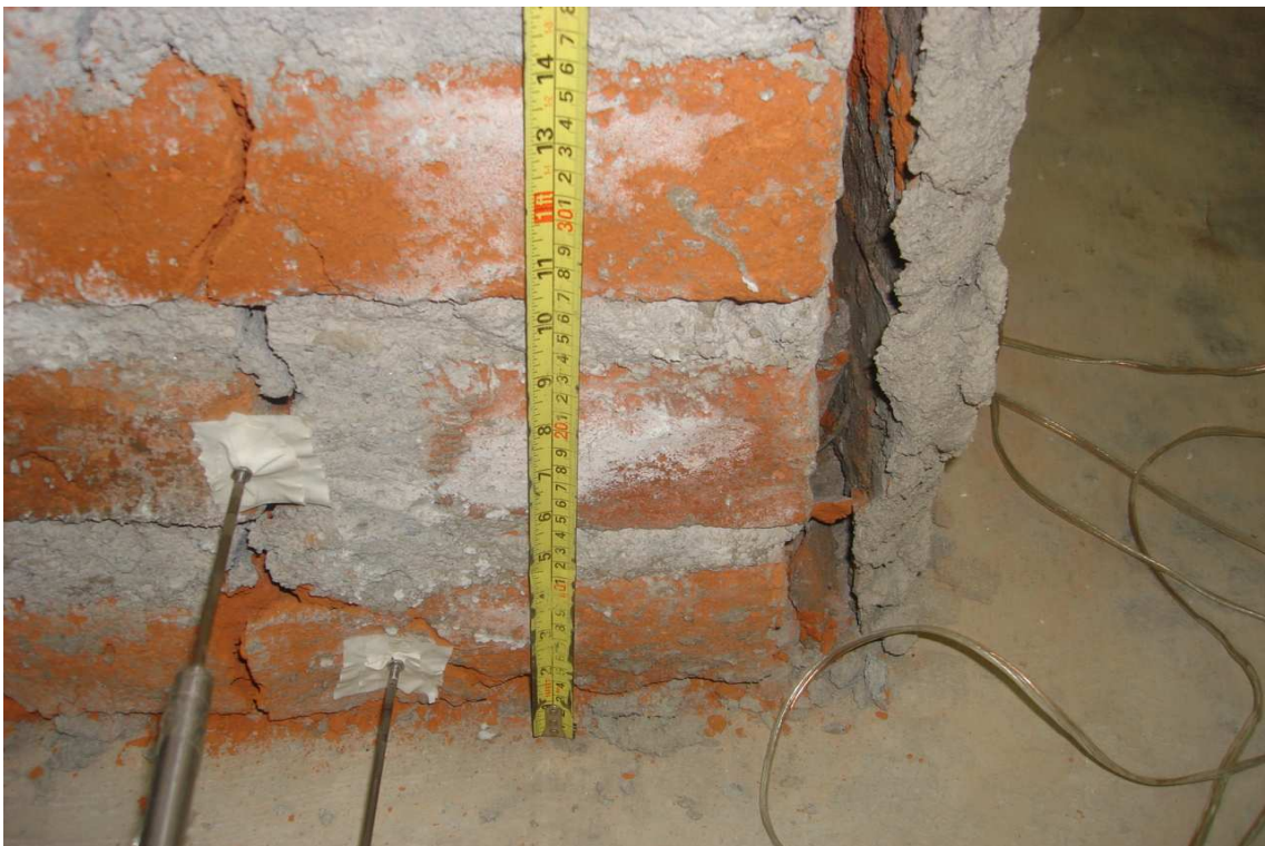
Fotografía 5.29: Desprendimiento del enchape de refuerzo y grieta central en los ladrillos hasta 36 cm de altura.
