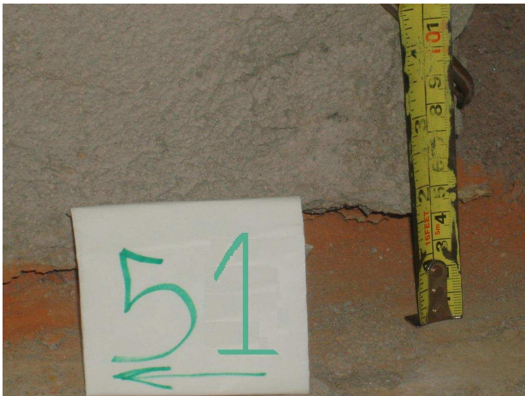
Fotografía 5.27: Levantamiento a causa del volcamiento a 51 t de carga lateral.
