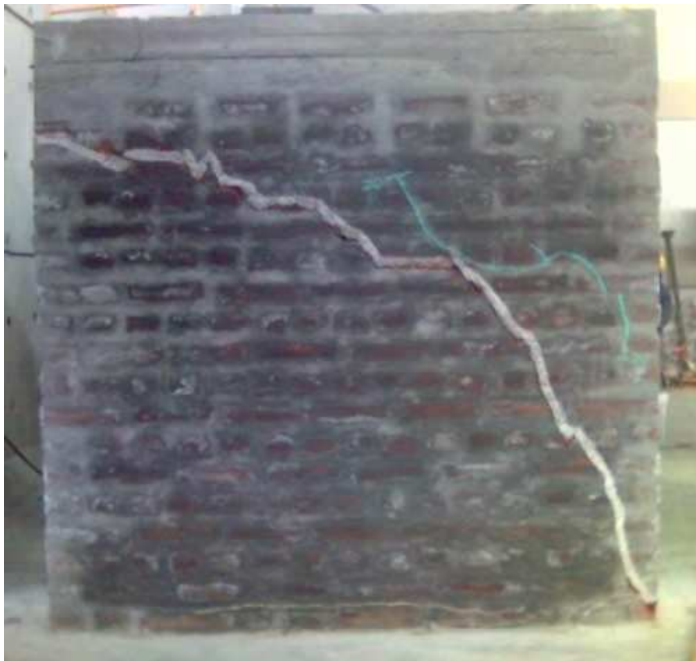
Fotografía 4.19: Condición de la mampostería ensayada agrietada previa a realizar su rehabilitación y reforzamiento.
