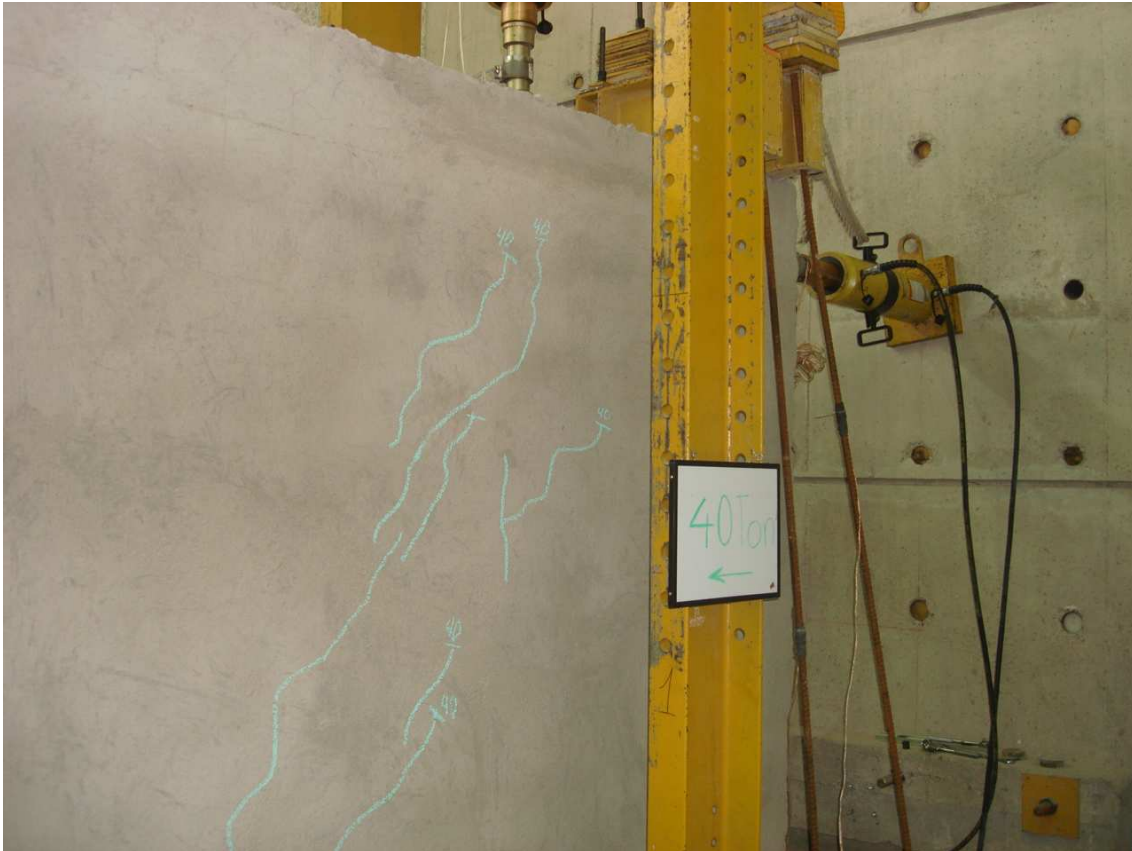
Fotografía 5.24: Fisuras en la pared a las 40 t de carga positiva
