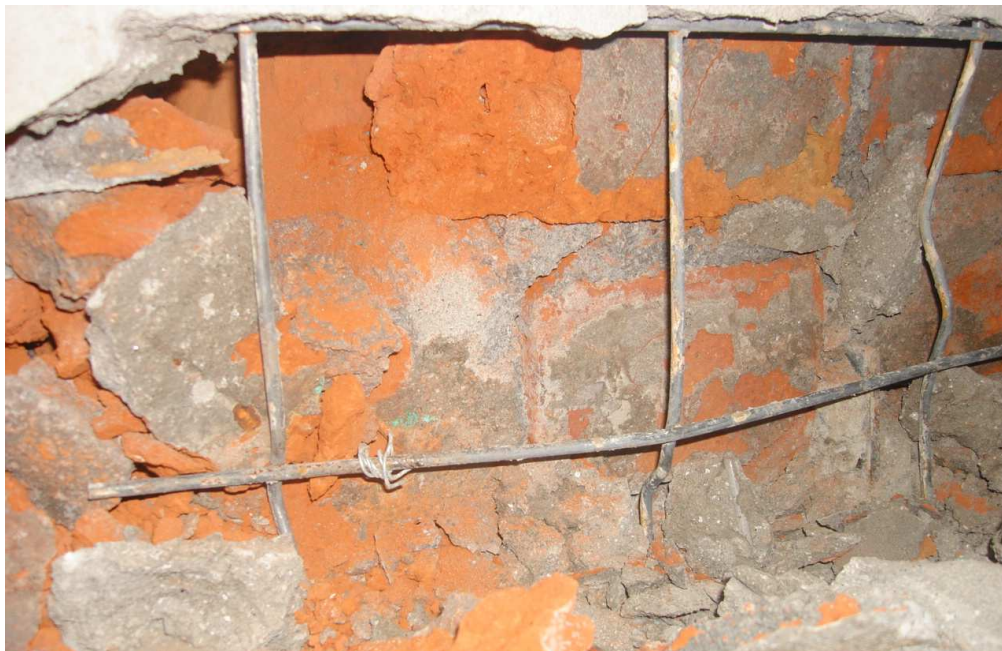
Fotografía 6.11: Malla electrosoldada deformada por pandeo durante la realización del ensayo, vínculo aún amarrado a la malla de refuerzo.
