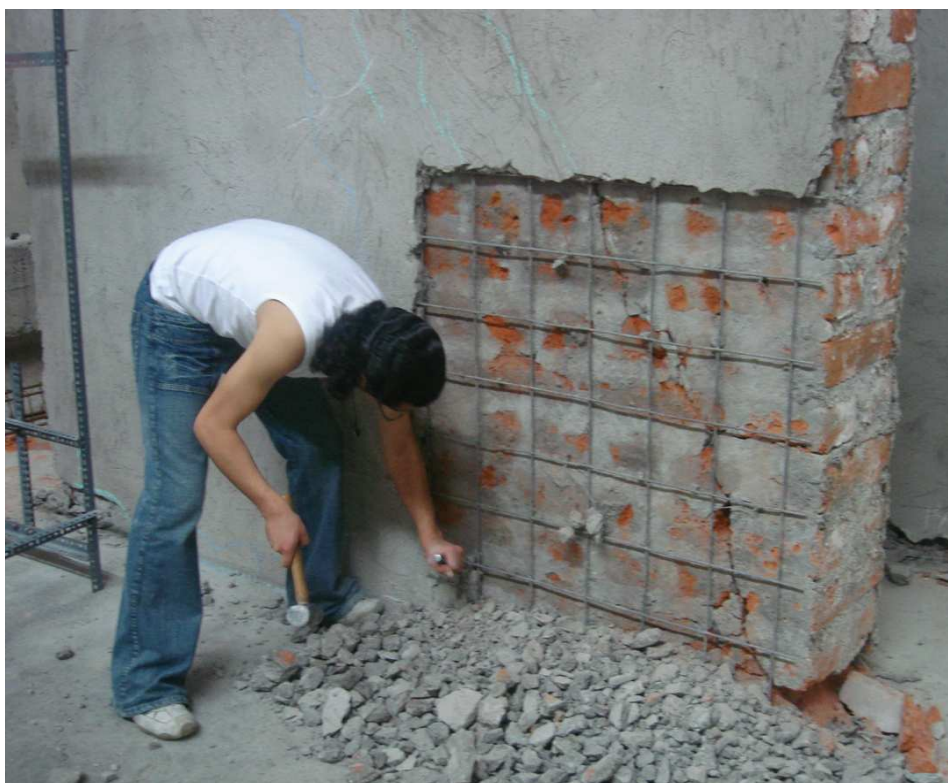
Fotografía 6.6: Procedimiento de retiro del enchape para verificación de grietas.
