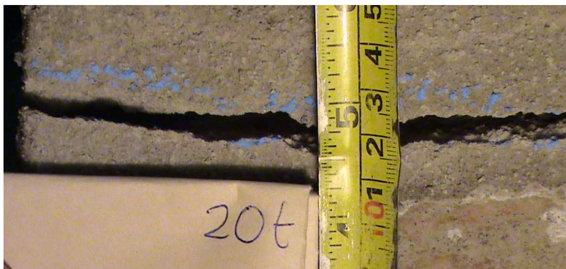
Fotografía 5.9: Ancho Fisura en la pared a las 20 t. de carga positiva.
