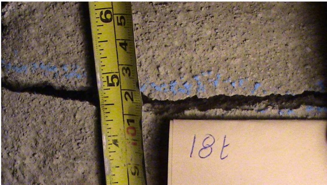
Fotografía 5.8: Ancho Fisura en la pared a las 18 t. de carga positiva.
