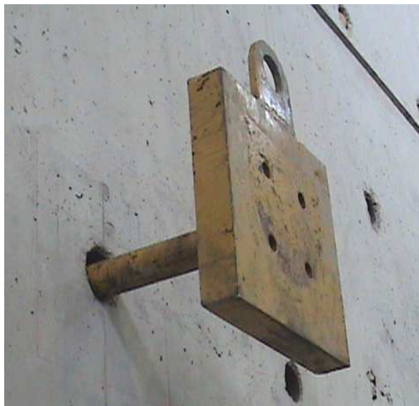
Fotografía 3.11: Placa de empotramiento del gato hidráulico
