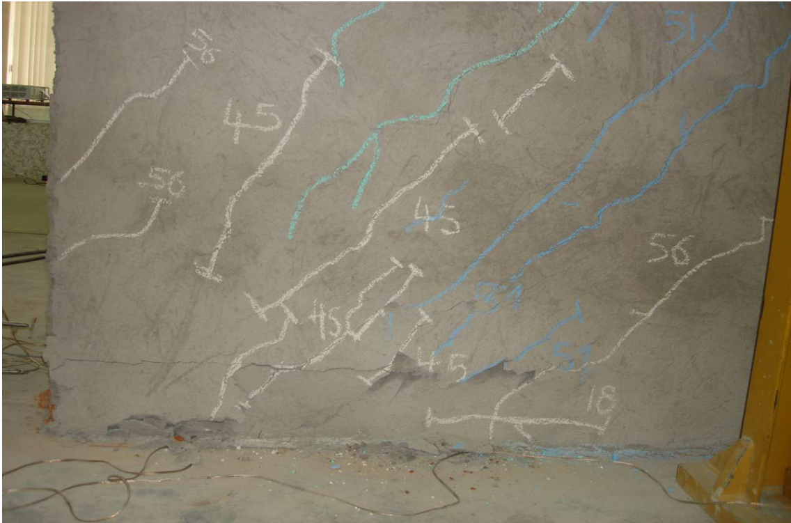
Fotografía 5.28: Agrietamiento final de la mampostería.
