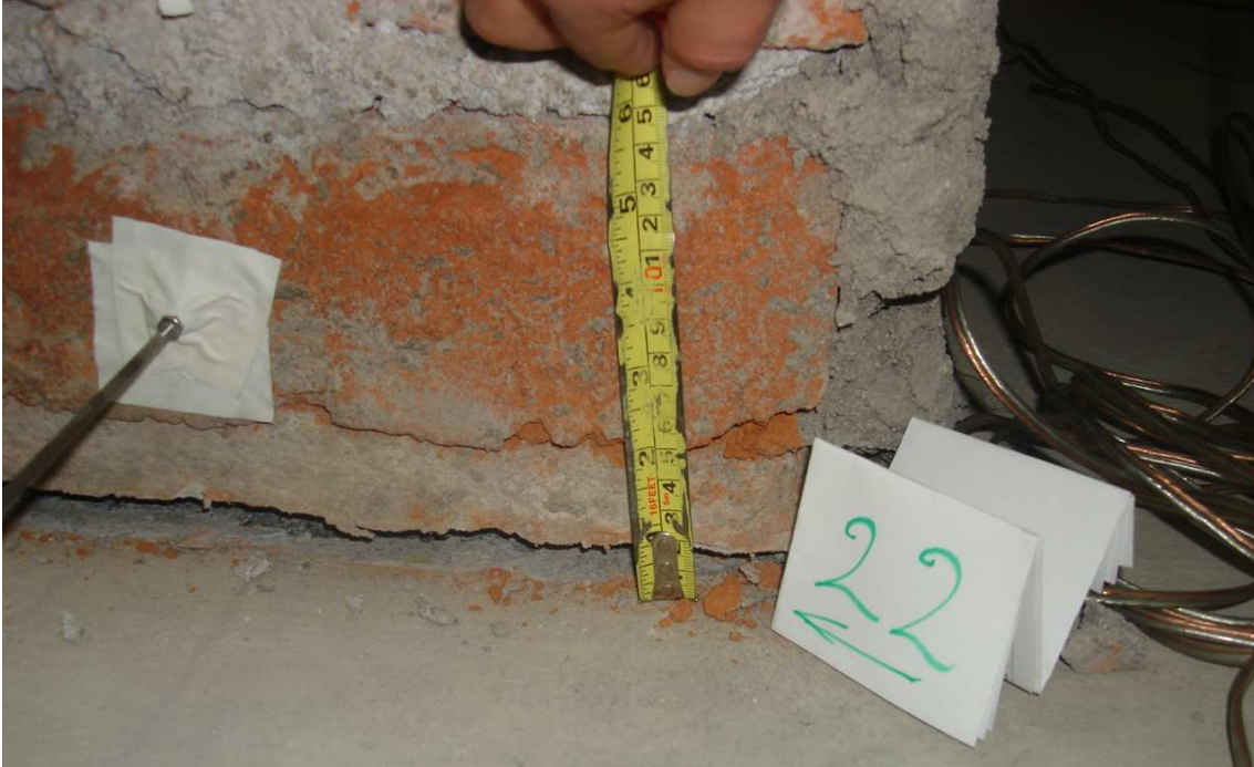
Fotografía 5.12: Efecto de volcamiento (levantamiento de la pared)
