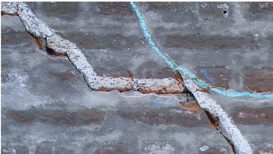
Fotografía 6.3: Grieta en parte central de la pared agotada.
