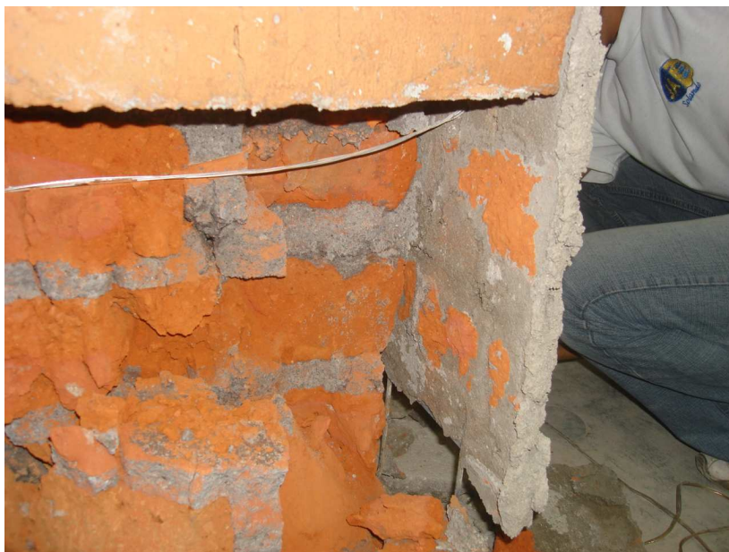
Fotografía 6.10: Alambre galvanizado en su posición original aún después de haber concluido el ensayo.
