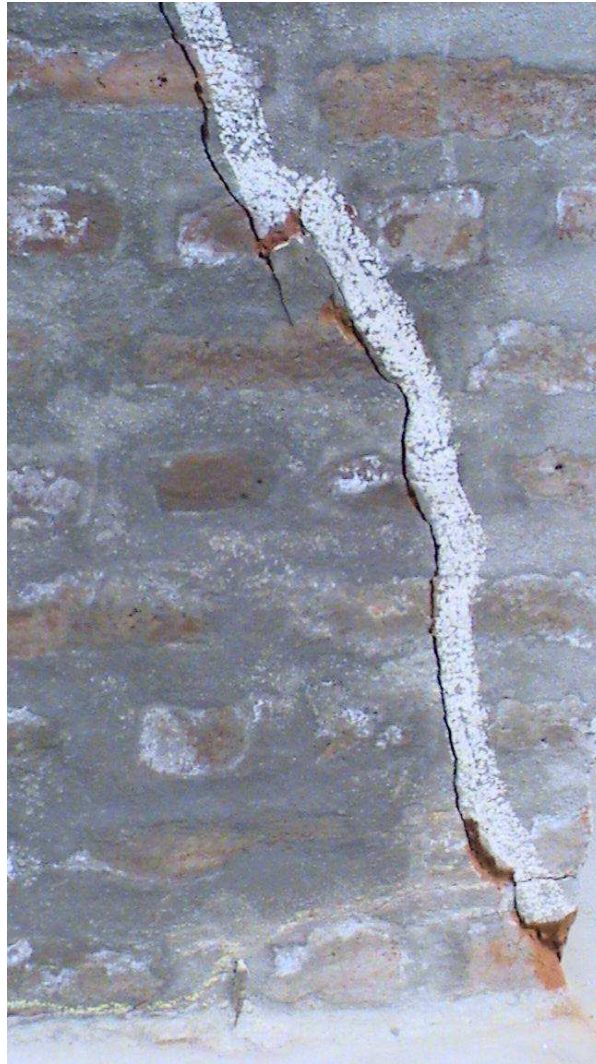
Fotografía 6.4: Grieta en esquina inferior derecha de la pared agotada.
