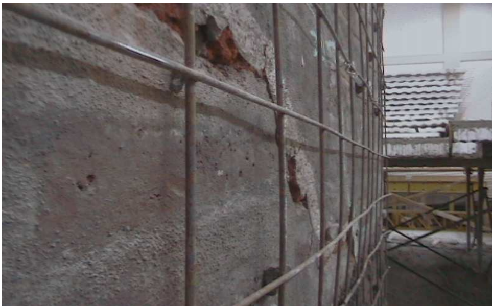
Fotografía 4.21: Separación de la malla electrosoldada de la pared 1 cm.
