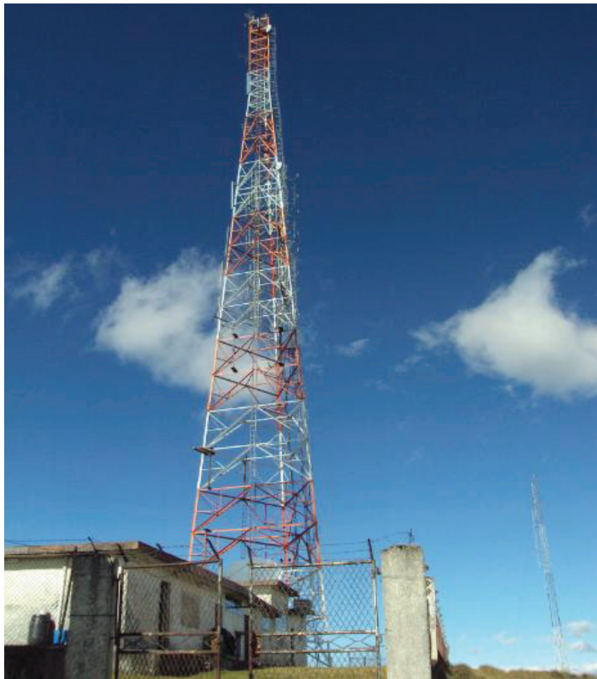
Figura 3.25 Torre Autosoportada Cerro Atacazo vista trasera
