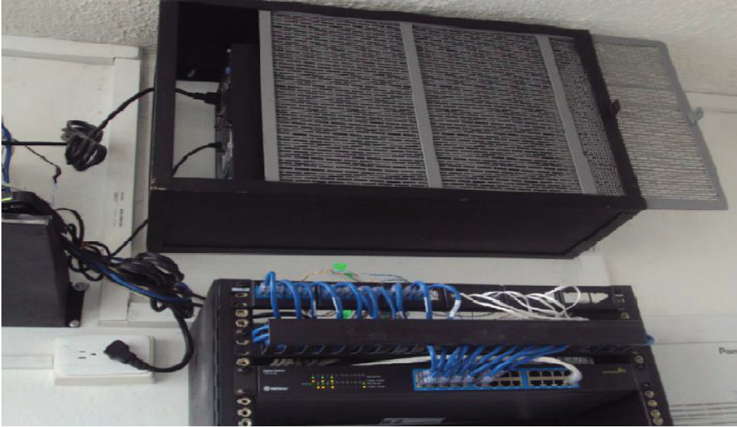
Figura 2.3 Equipos de comunicación de la Cooperativa
