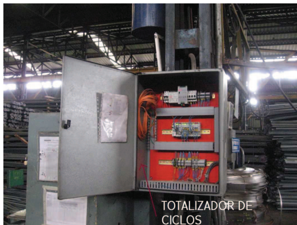
Figura 1.31 Caja de Control de la Cizalla CV20 del Tren de Laminación
