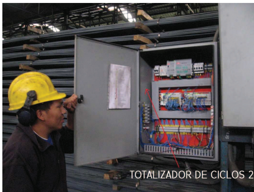
Figura 1.34 Caja de Control de la Mesa de Enfriamiento
