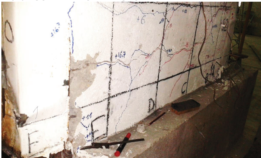
FIGURA 5. 6 AGOTAMIENTO DEL MURO 1
