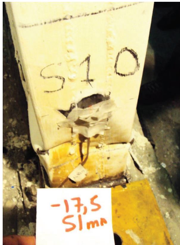
FIGURA 5. 3 AGOTAMIENTO DEL CABEZAL DEL MURO 1
