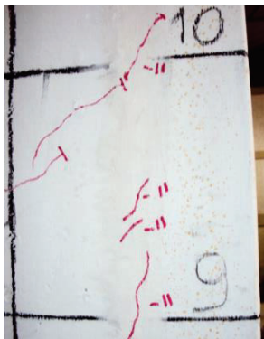
FIGURA 4. 14 DETALLE X_FISURA APARENTE.
