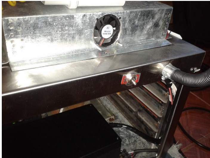
Figura 4.10. Ventiladores instalados para extracción de gas en la planta.
