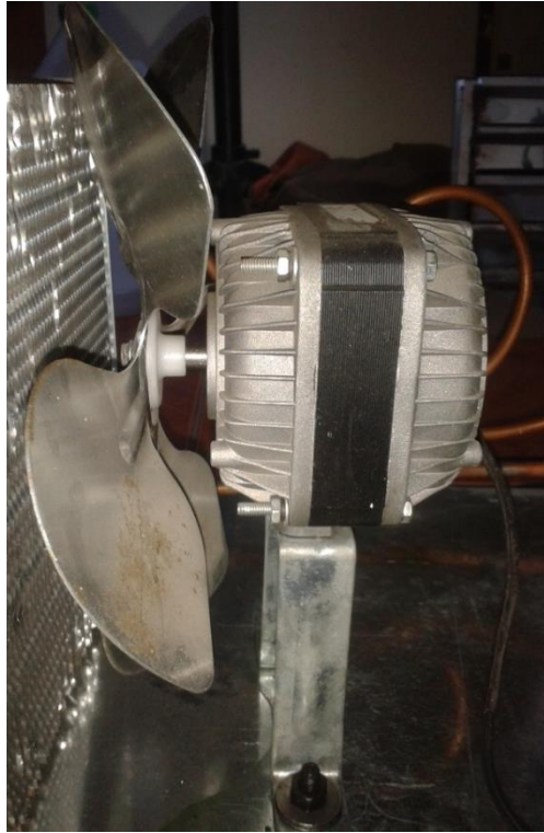
Figura 2.10. Ventilador Instalado en la Planta
