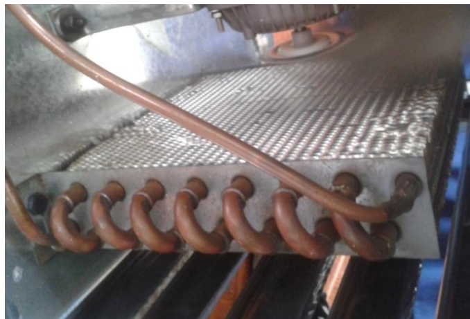
Figura 2.8. Condensador Instalado en la Planta
