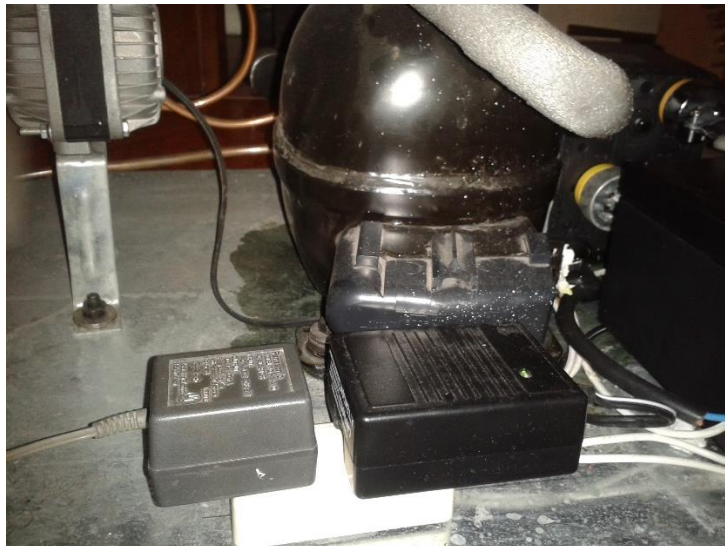
Figura 2.44. Fuentes de corriente continua conectadas en la Planta.
