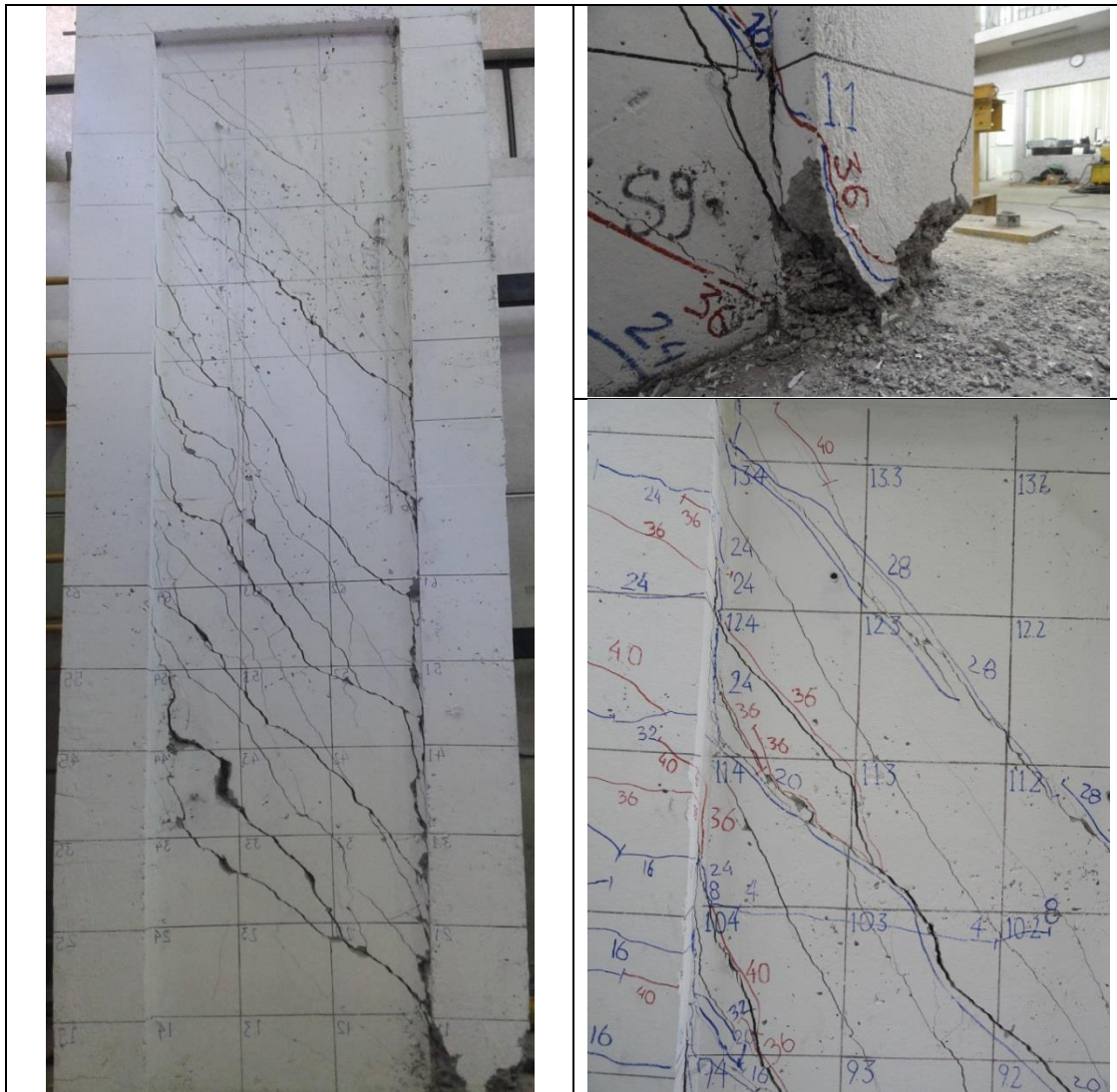
FIGURA 5.18: Agotamiento Muro M3
