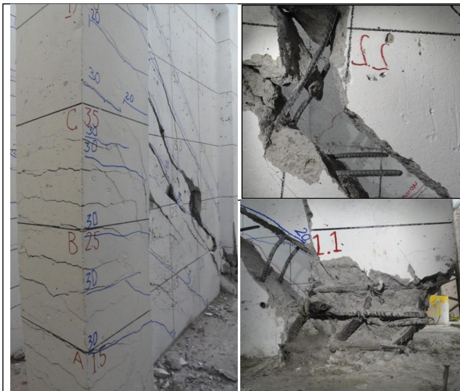
FIGURA 5.8: Rotura de refuerzo transversal muro M1
