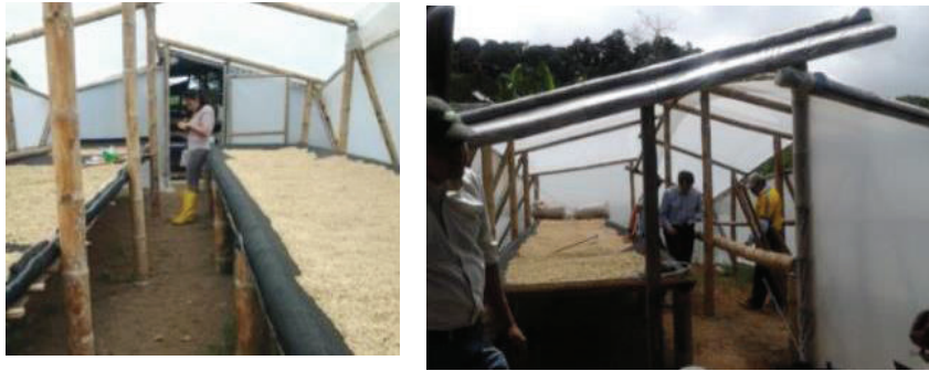
Figura 3. 7 (a) Dimensiones físicas de la Marquesina (b) Construcción de marquesinas de secado
