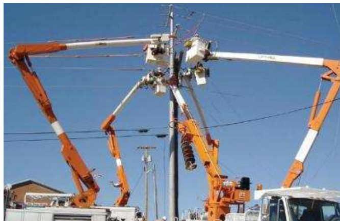
Figura 1.30 Instalación aérea de fibra óptica [12]
