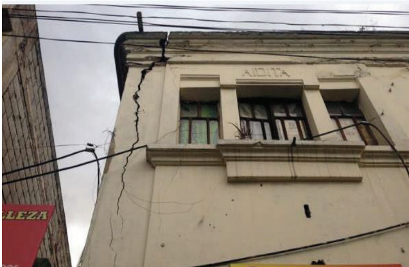
FIGURA 1.2 Casa en Calderón, afectada por el sismo de Agosto del 2014
