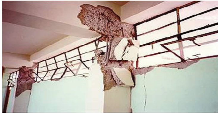
FIGURA 1.13 FALLA POR “COLUMNA CORTA”.
