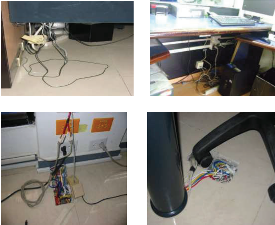
Figura 3.42. Sistema eléctrico defectuoso
