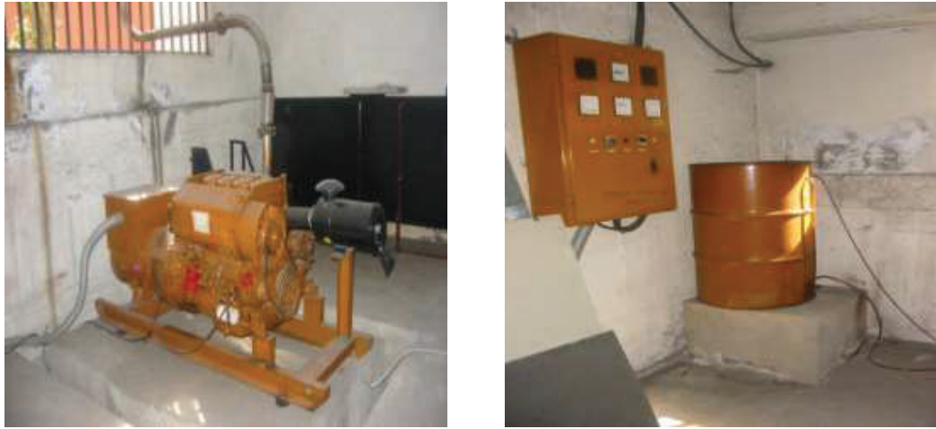
Figura 3.41. Grupo electrógeno, Subsuelo No.1
