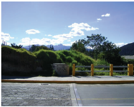
FOTOGRAFÍA N° 15 Entrada AR-01, Descarga alcantarilla San Carlos
