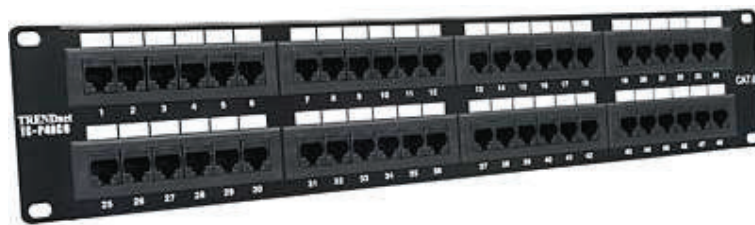
Figura 1.11 Panel de conexión de 48 puertos [W13]
