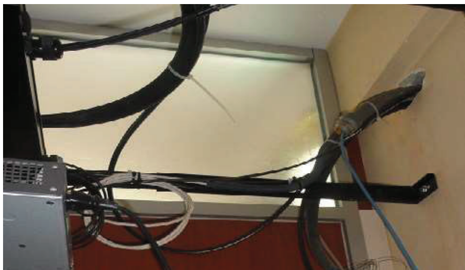
Figura 2.27 Entrada de servicios.
