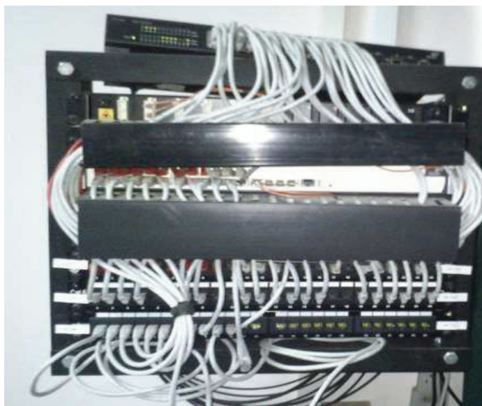
Figura 2.24 Rack de pared del laboratorio de Informática de 9no. de Básica a 1ro. de Bachillerato.
