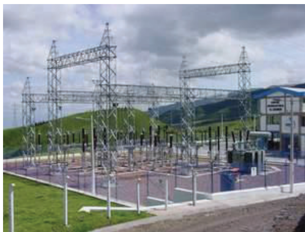
Figura 1.2 Subestación eléctrica El Carmen
