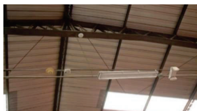
Figura 1.6 Detectores de humo y luces de emergencia Fuente: Baldosines Alfa S.A.
