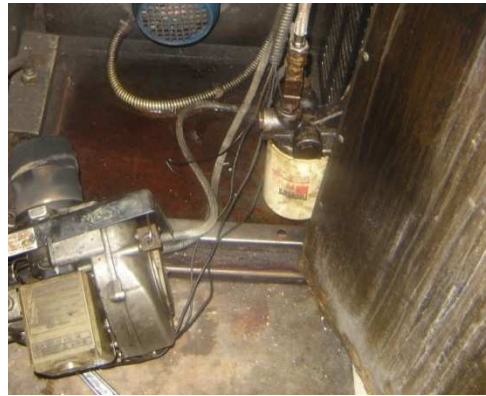
Figura A1.64 Quemador y filtro de combustible
