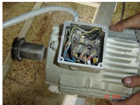
Figura A1.44 Conexiones eléctricas
