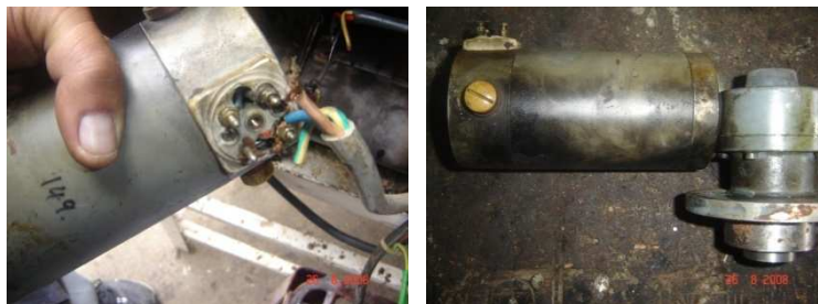
Figura A1.153 conexiones eléctricas
