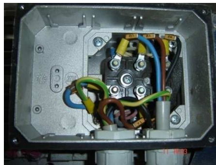
Figura A1.16 Conexiones eléctricas
