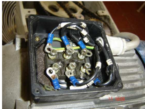
Figura A1.185 Conexiones eléctricas
