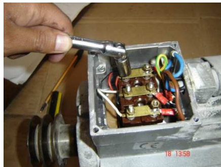
Figura A1.167 Conexiones eléctricas
