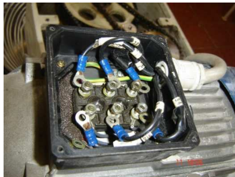
Figura A1.178 Conexiones eléctricas
