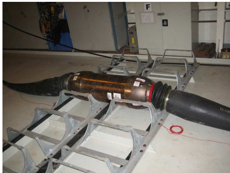
Fig. 22 Imagen de repetidor instalado
