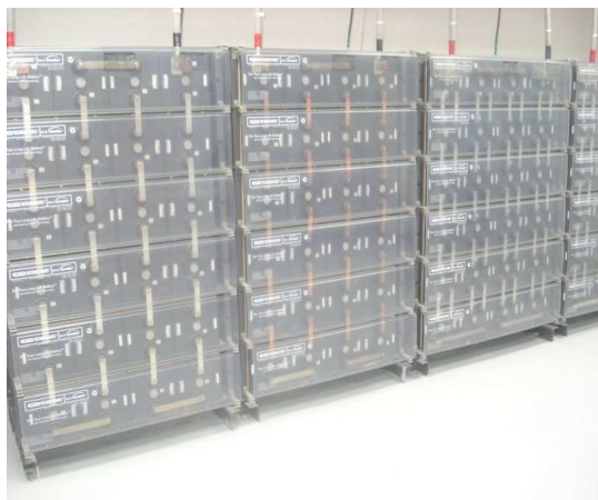
Fig. 38 Banco de baterías
