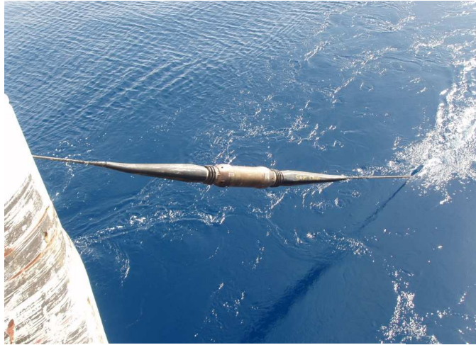
Fig. 19 Repetidor utilizado en la instalación
