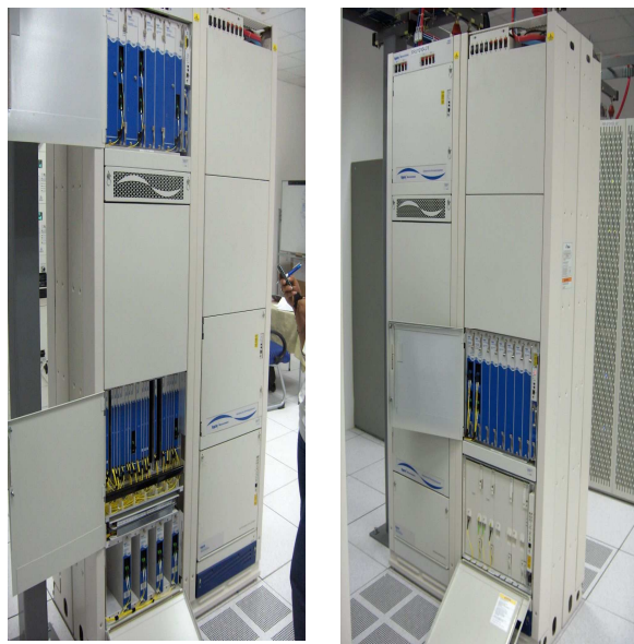
Fig. 30 Equipos SLTE instalados por TIWS
