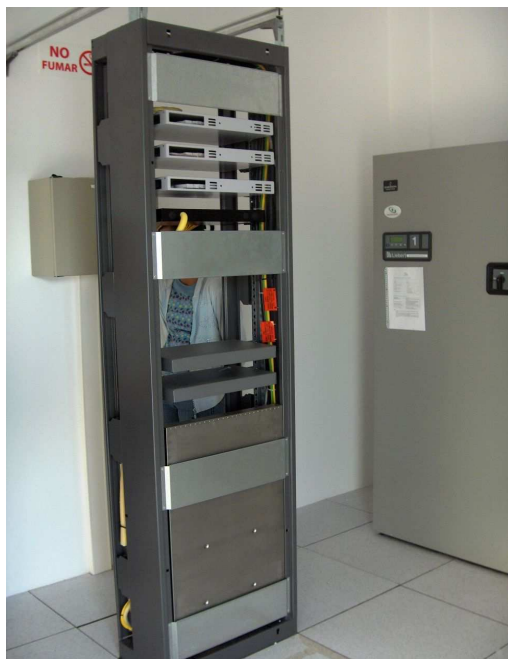
Fig. 39 Bastidor de cliente SURATEL
