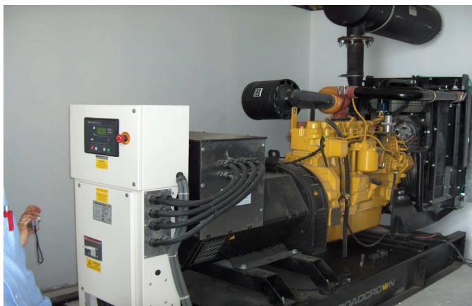
Fig. 37 Generadores de emergencia
