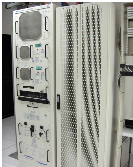
Fig. 34 Imagen del PFE instalado
