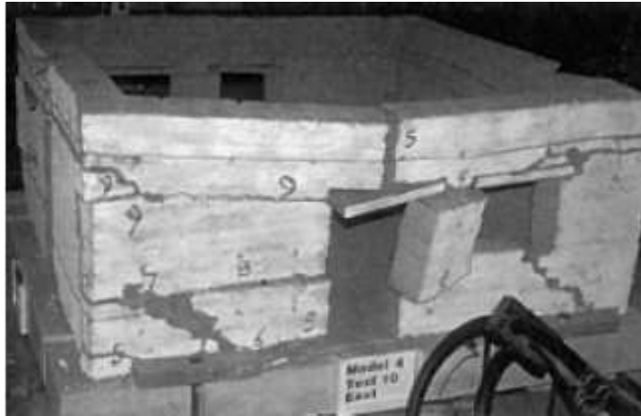
Figura 3-11 a 3-13. Grietas típicas producidas por impactos sísmicos simulados en modelos (Tolles et al. 2000)
